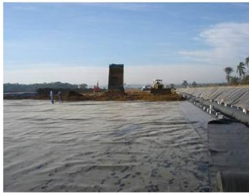
Figura 2.5: Geomembrana em PEAD em aterro sanitário (Fonte: SANTEC RESÍDUOS, 2005).
