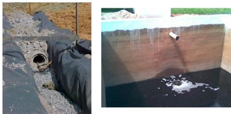
Figura 2.6: Dreno (E) e tanque (D) de chorume. (Fonte: SANTEC RESÍDUOS, 2005).
