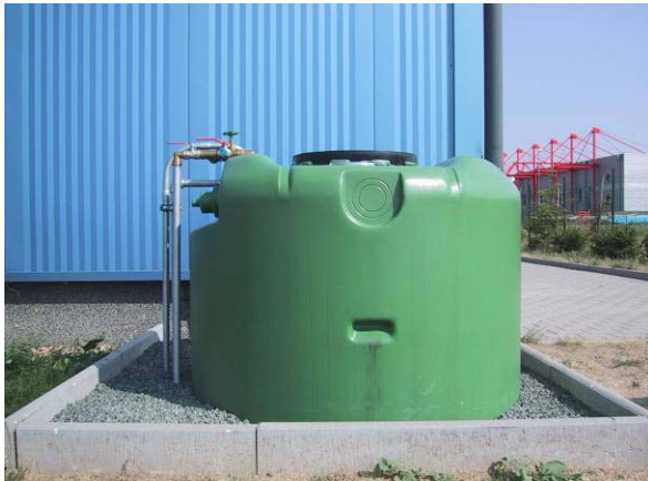
Depósito de água bruta do sistema de tratamento d'água
