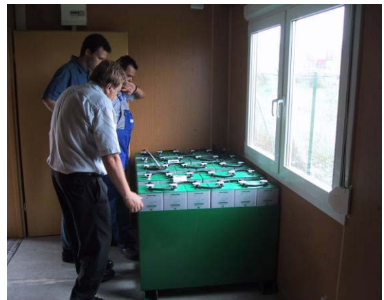
Acumuladores do sistema de baterias para compensar oscilações na oferta de energia
