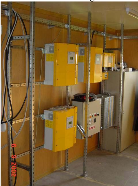
Unidade de controle e de comando do sistema híbrido no contêiner da estação
