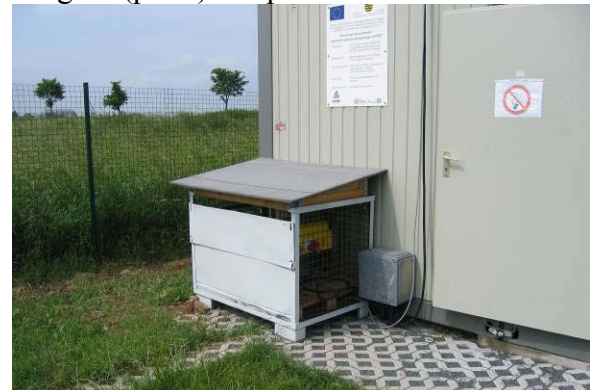
Gerador a óleo diesel com potência nominal de 5 kW, na área externa do contêiner
