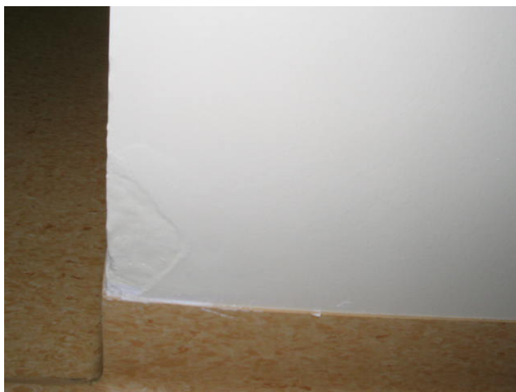
Figura 50: detalhe de acabamento insatisfatório
