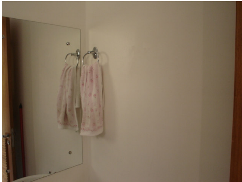
Figura 48: solução do problema de desgaste da parede de gesso acartonado
