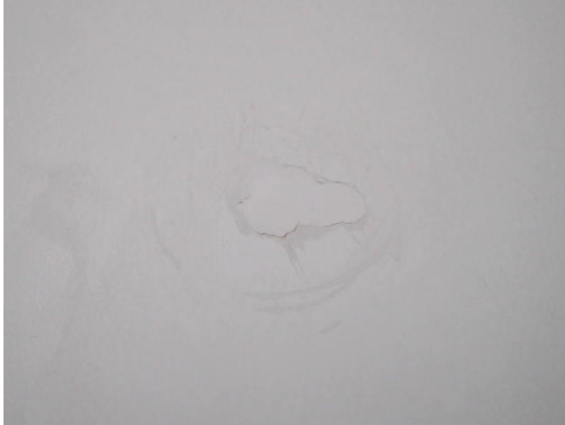
Figura 47: patologia na parede de gesso acartonado
