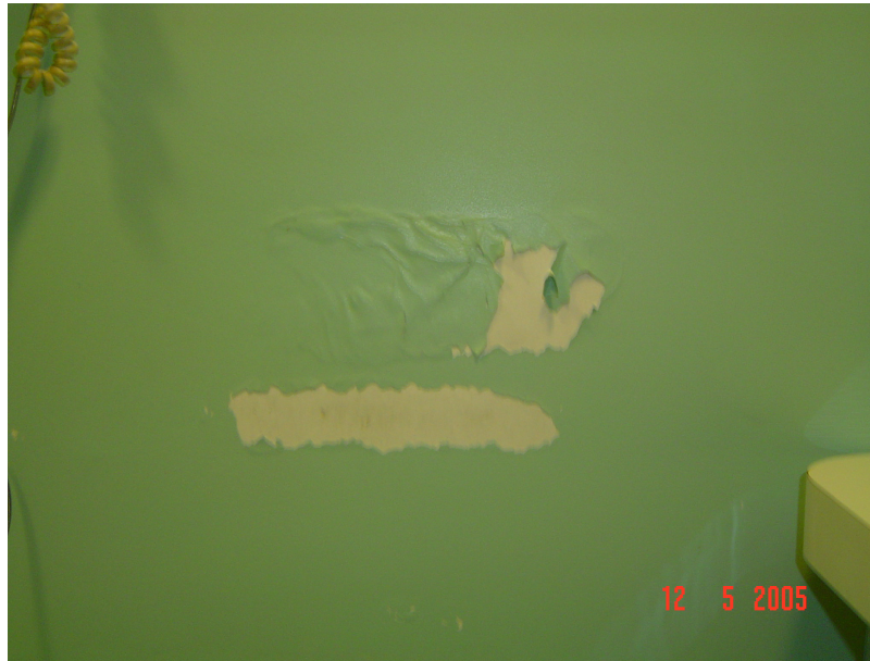
Figura 45: descolamento de pintura da parede de gesso acartonado
