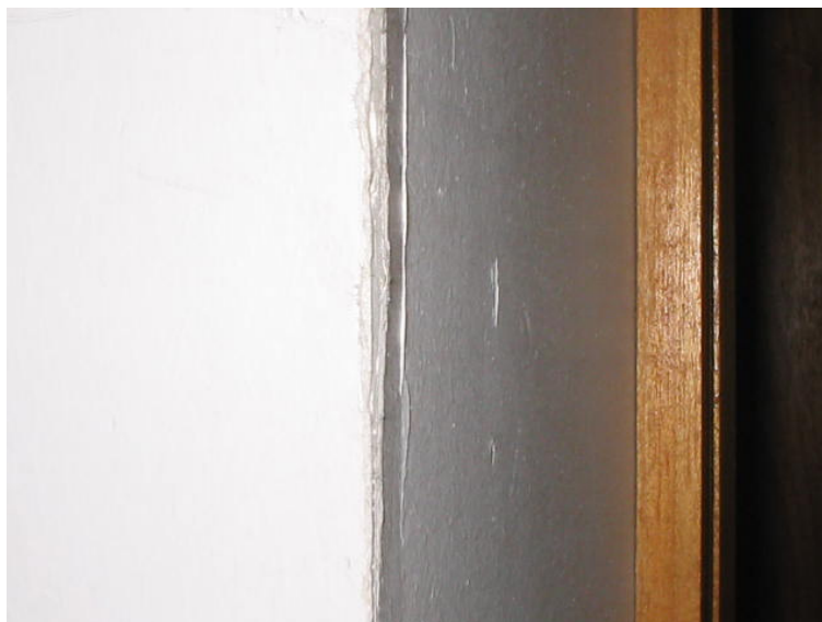
Figura 49: detalhe de acabamento insatisfatório na junta das chapas
