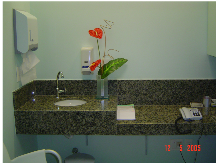
Figura 52: bancada com instalações em parede de gesso acartonado
