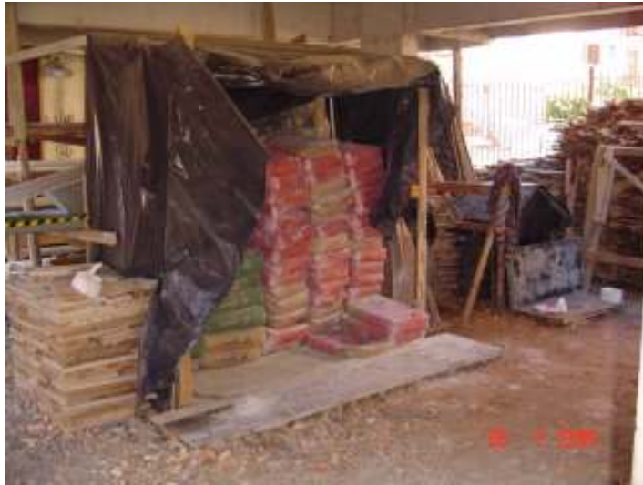
Figura 6: Armazenamento do cimento e da cal hidratada no pavimento sobre pilotis: pilhas com excesso de sacos
