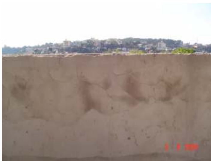
Figura 23: Fissuras no revestimento de argamassa
