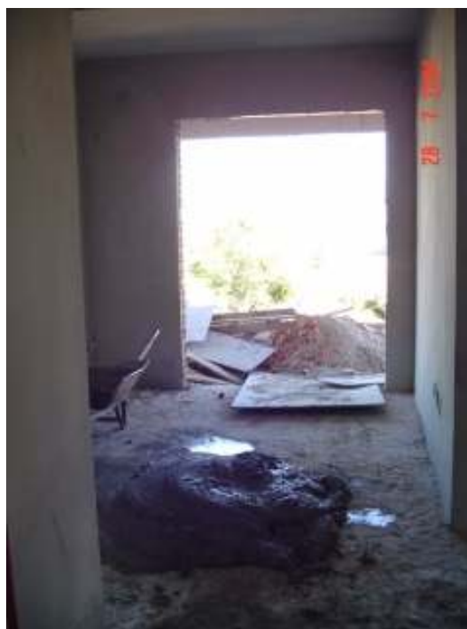
Figura 15- Armazenamento da argamassa no chão de forma indevida
