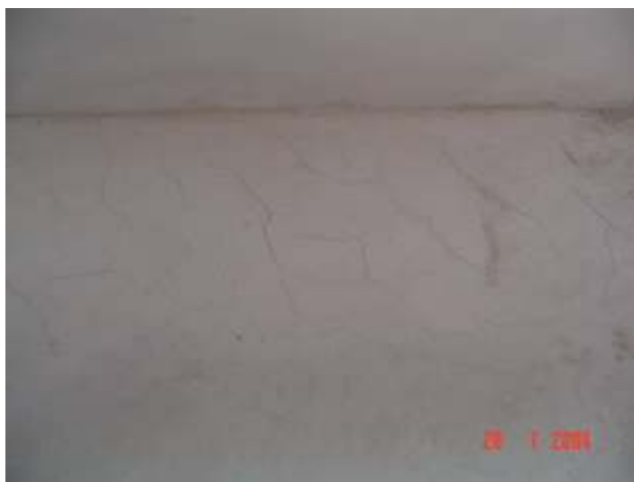
Figura 4 - Fissuras no revestimento de argamassa com poucos dias de idade
