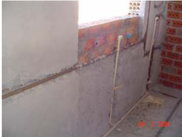
Figura 1: Espessura excessiva do revestimento interno de argamassa em função da interferência de serviços de hidráulica
