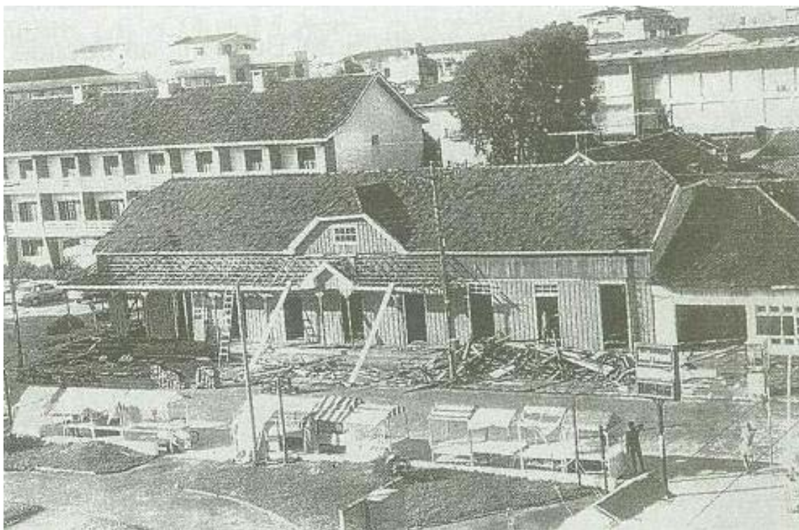
FIGURA 5.14 – Demolição do Prédio do Boliche na Praça José Agostinelli esquina Rua Sepé. Prédio do Hotel Riograndense à esquerda – Capão da Canoa (RS)
