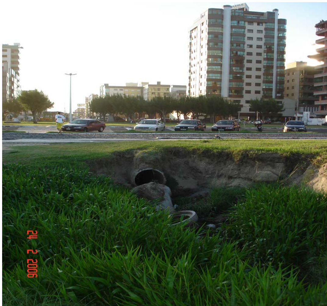
FIGURA 5.49 – Canalização pluvial destruída no pós-praia, eixo da Praça Luiz Bassani no bairro Navegantes em Capão da Canoa
