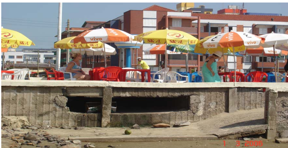
FIGURA 5.47 – Galeria pluvial passando sob o calçadão na orla central de Capão da Canoa
