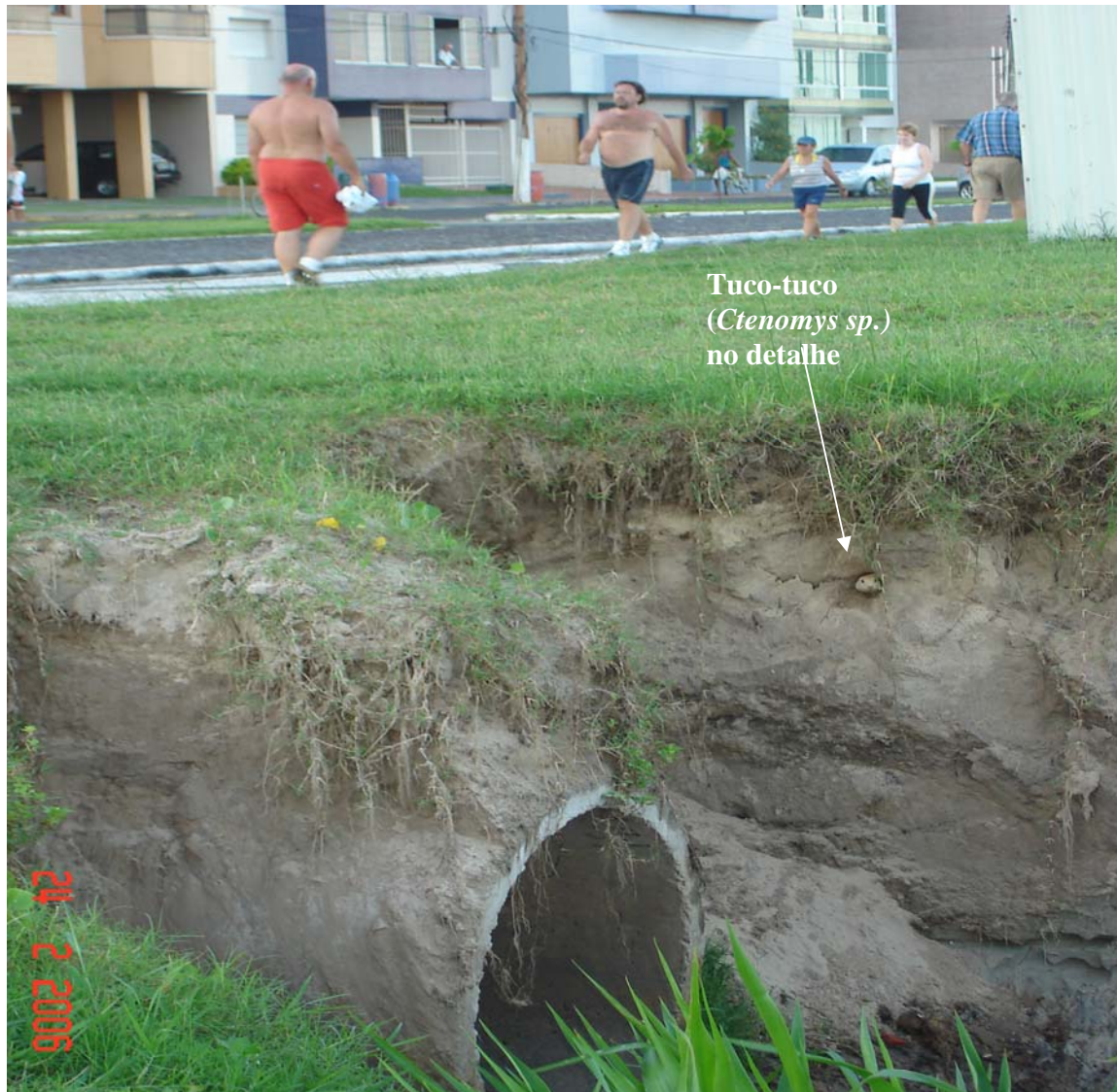
FIGURA 5.45 – Canalização com deságüe pluvial no pós-praia em Capão da Canoa
