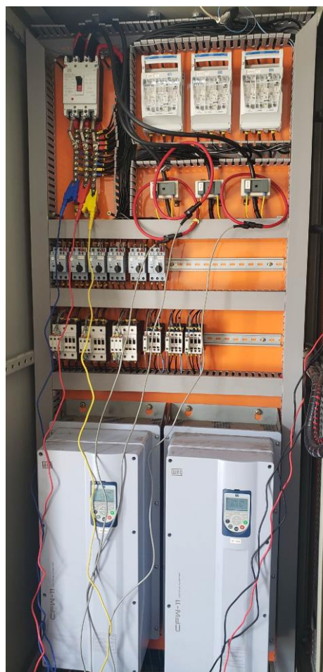
Figura 10. Quadro de comando.
