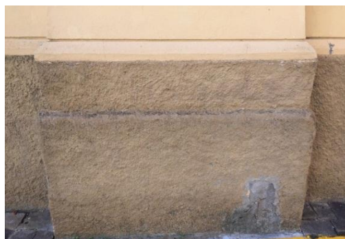
Figura 138 - Região com argamassa aplicada à edificação em período posterior à construção, referente à figura 137
