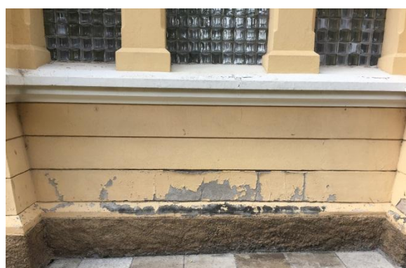
Figura 126 - Região da figura 125 com manifestações patológicas identificadas com a termografia
