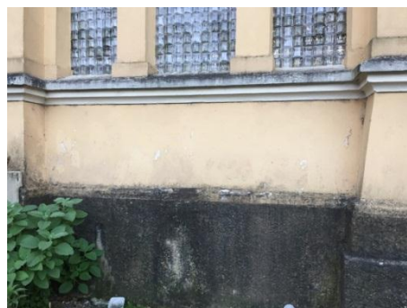
Figura 132 - Aparência real da fachada sul - ala esquerda em região analisada com termografia apresentada pela figura 131
