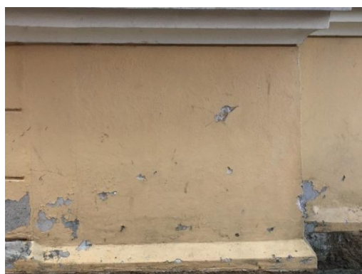
Figura 141 - Fachada oeste em região analisada com termografia e apresentada pela figura 140
