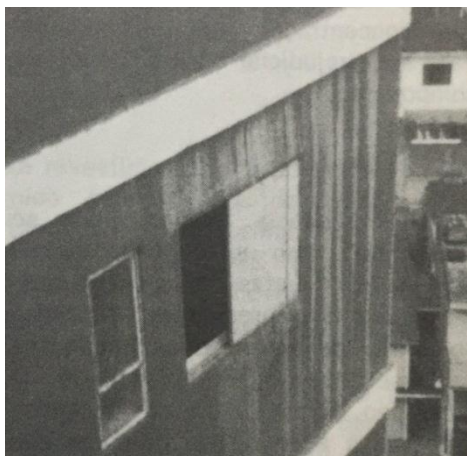
Figura 15 - Eflorescência do tipo II em revestimento de argamassa
