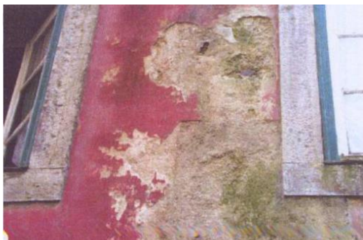
Figura 6 - Desagregação em revestimento de argamassa
