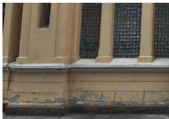
Figura 120 - Região da figura 119 com manifestações patológicas identificadas com a termografia
