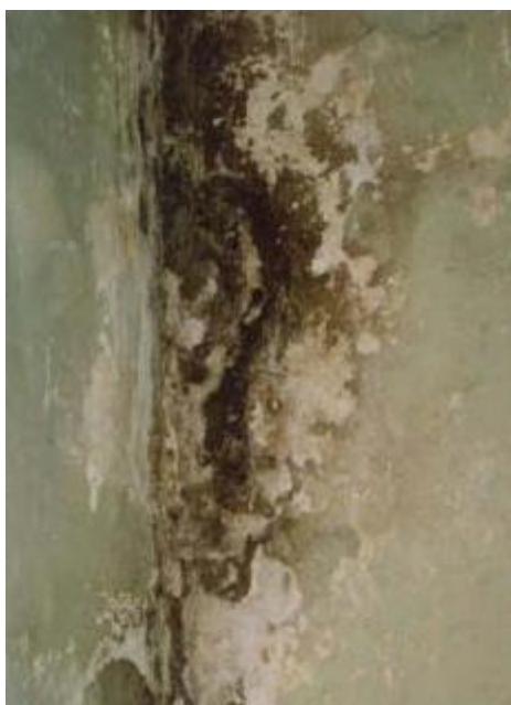
Figura 14 - Biodeterioração em reboco - biofilme
