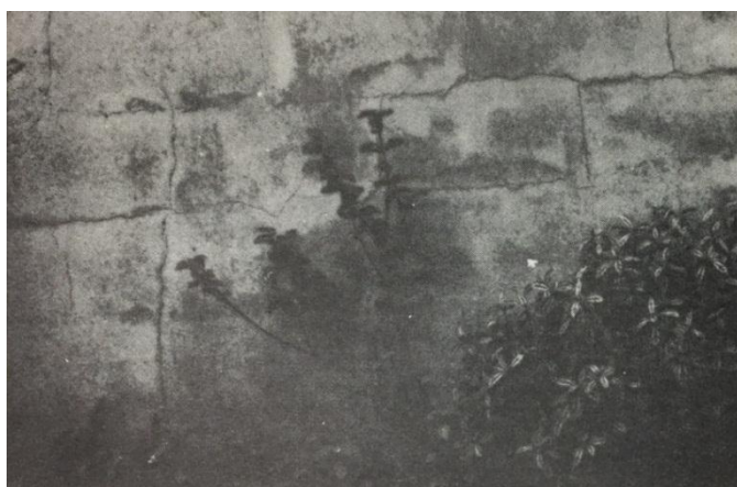
Figura 4 - Fissuras geométricas contornando os componentes da alvenaria
