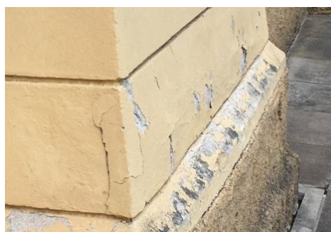
Figura 112 - Possibilidade de criptoflorescência na fachada norte - ala esquerda
