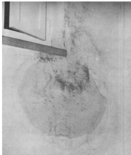
Figura 12 - Mancha de umidade de infiltração em parede
