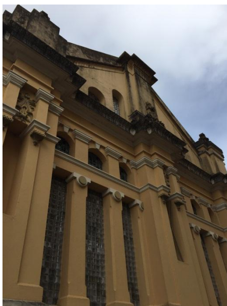
Figura A20 – Reentrâncias laterais e saliências da fachada leste - vista 2 - detalhe região de topo
