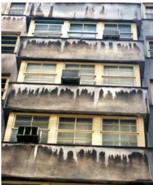
Figura 8 - Manchamento no revestimento de fachada
