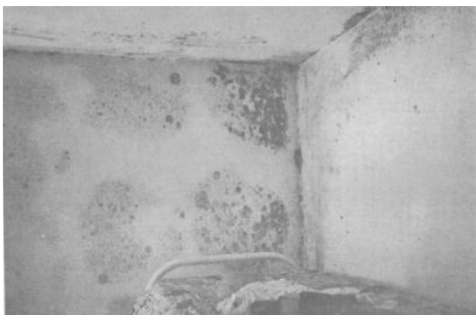
Figura 13 - Mancha de bolor em parede induzida pela umidade de condensação
