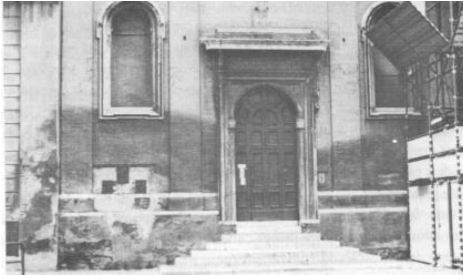
Figura 11 – Manchamento causado por umidade ascensional do terreno
