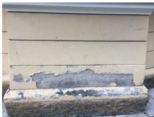
Figura 124 - Região da figura 123 com manifestações patológicas identificadas com a termografia
