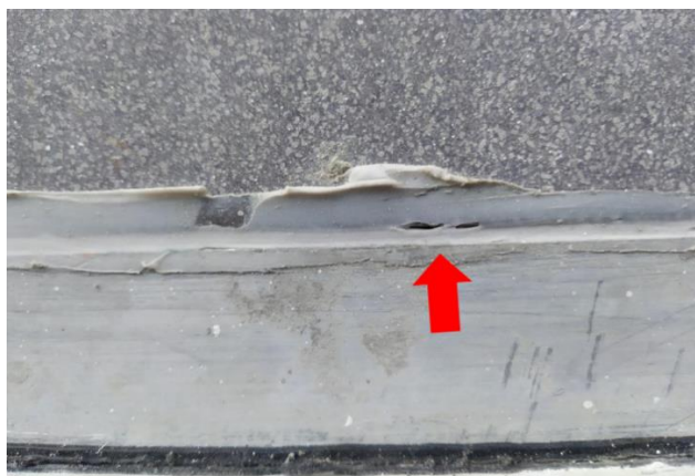
Figura 90: Falhas de vedação entre peitoril e contramarco
