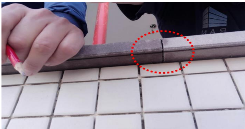
Figura 81: Falha na interface peitoril e revestimento externo
