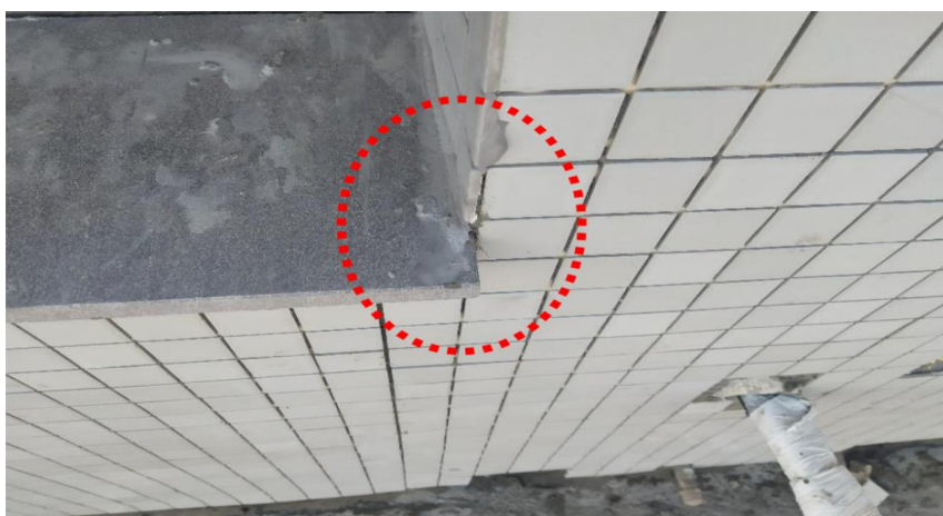
Figura 82: Falha na interface peitoril e revestimento externo
