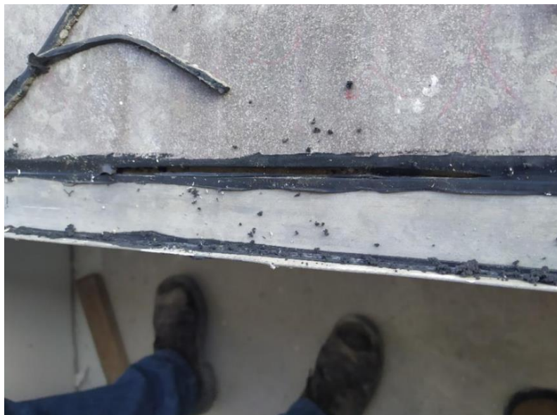
Figura 92: Falta de tarucel na vedação entre peitoril e contramarco esquadria retirada
