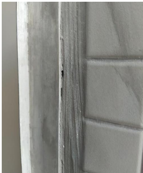
Figura 79: Falha de vedação do revestimento externo
