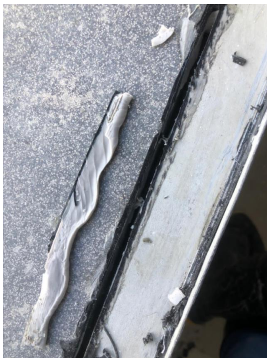
Figura 93: Aproximação falta de tarucel na vedação entre peitoril e contramarco esquadria retirada
