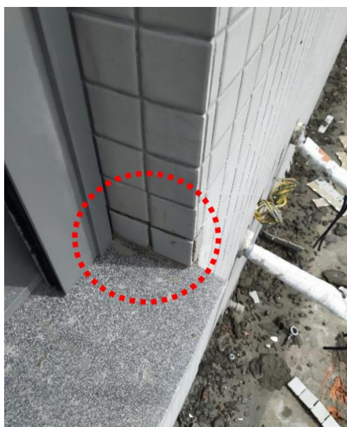
Figura 80: Falha na interface contramarco, peitoril e revestimento externo
