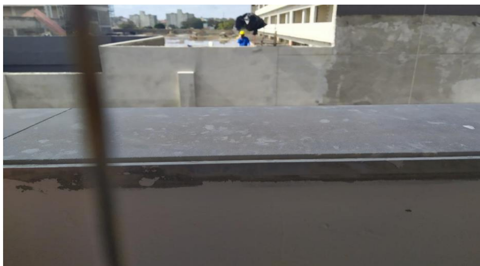
Figura 83: Falha na interface peitoril e contramarco
