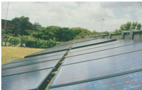
Figura 30: Prédio do IEE/USP com módulos fotovoltaicos em sistema interligado à rede elétrica
