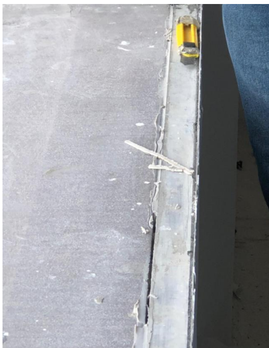
Figura 94: Falta de tarucel na vedação entre peitoril e contramarco esquadria retirada
