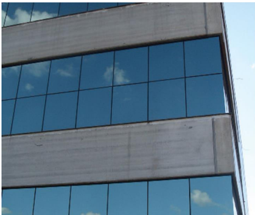
Figura 22: Edificação com esquadria entre vãos
