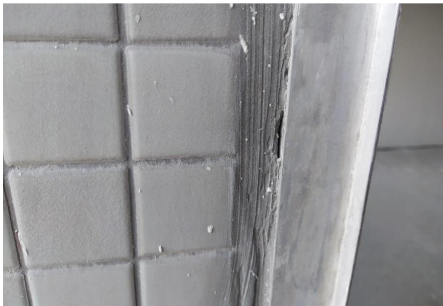
Figura 78: Falha de vedação do revestimento externo
