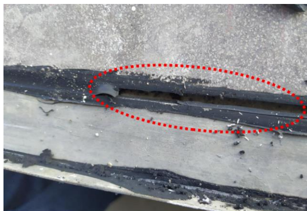
Figura 91: Demarcação falta de tarucel na vedação entre peitoril e contramarco esquadria retirada
