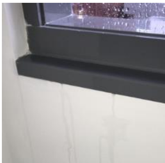
Figura 103: Falha na vedação do quadro fixo da esquadria
