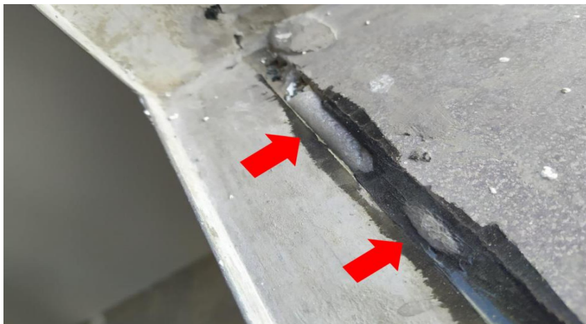
Figura 84: Falhas de vedação entre peitoril e contramarco
