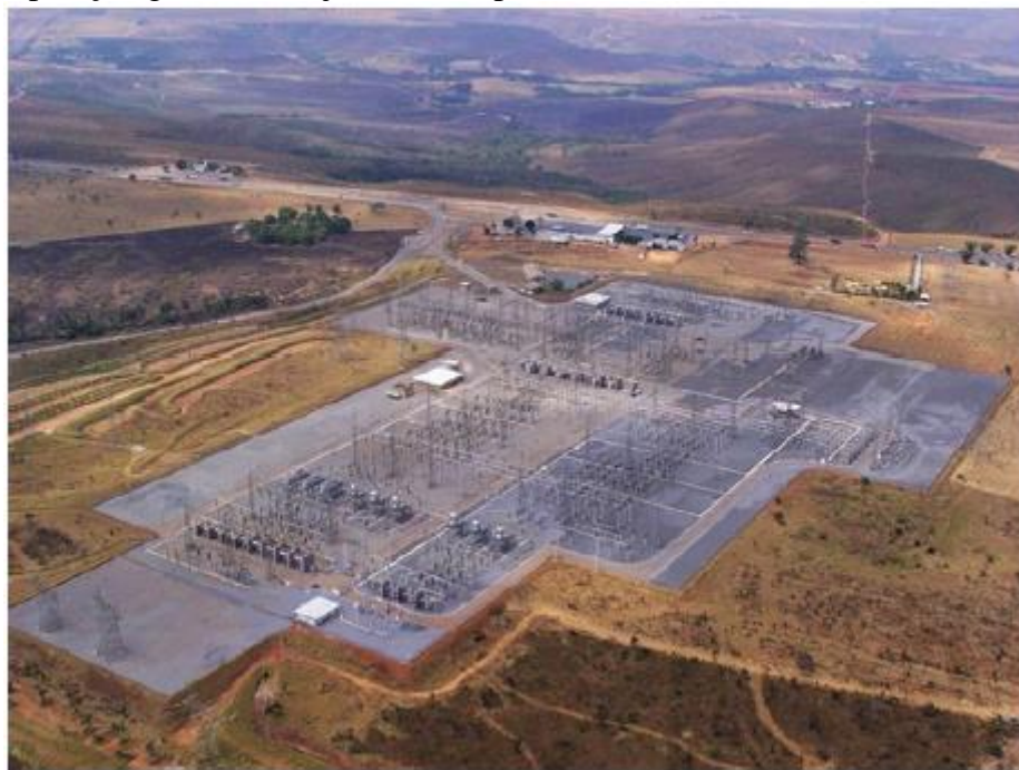
Figura 3. Disposição geral e arranjo físico do pátio de manobras da SE Samambaia-DF.
