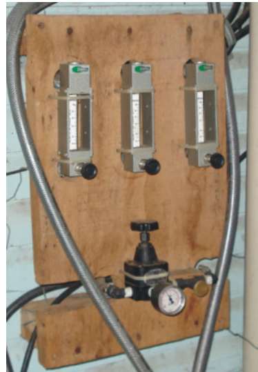
Figura 4.3 - Válvula reguladora de pressão e rotâmetros para o controle da vazão de alimentação de ar dos BAS
