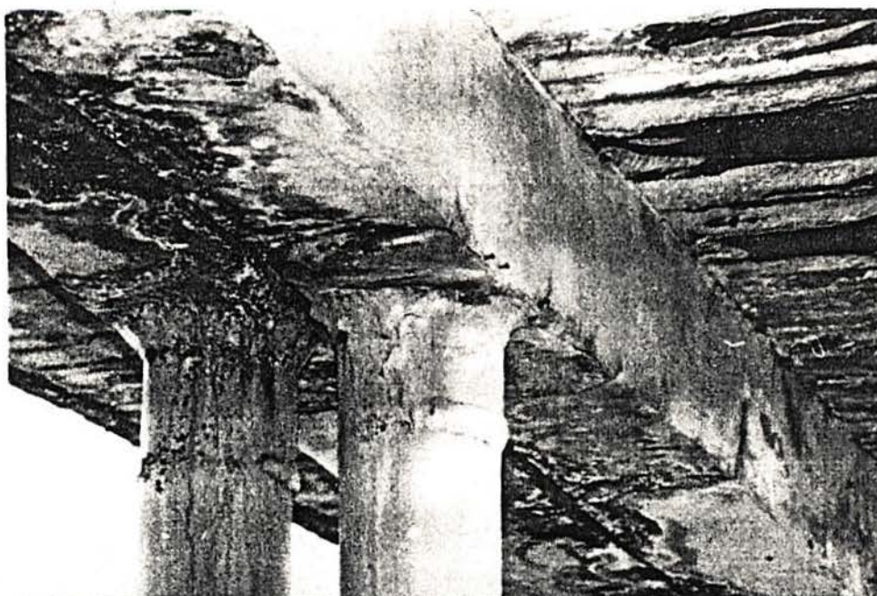
Foto 5.6 - Detalhe do tirante e viga protendidos da laje de cobertura (vão de 42 metros de balanço), onde pode-se observar cobrimentos insuficientes das armaduras, infiltrações, fungos, falta de manutenção das juntas de dilatação e corrosão das armaduras
