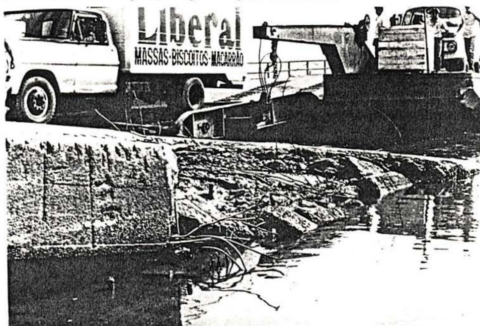
Foto 5.8 - Rampa para atracação de balsas destruída por impactos sucessivos
