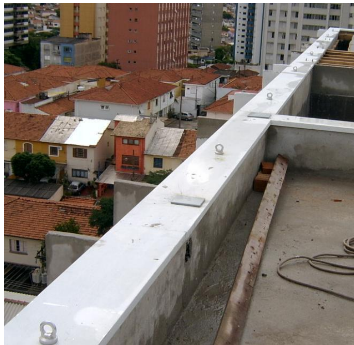
Figura 7 - Exemplo de sistema de ancoragem de cabos de segurança previsto no projeto arquitetônico.
