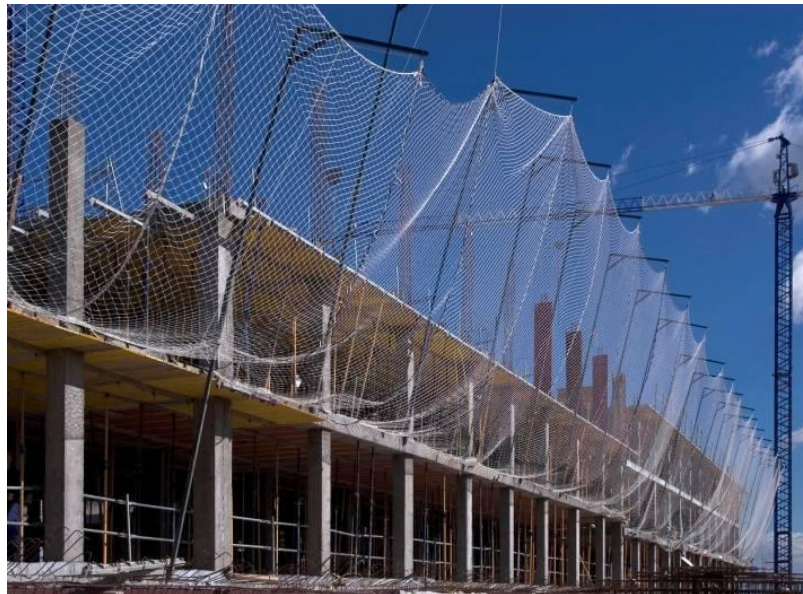
Figura 6 - Rede de segurança em substituição a plataforma secundária Fonte: Acervo pessoal Auditora Fiscal do Trabalho Luisa Tânia Rodrigues.
