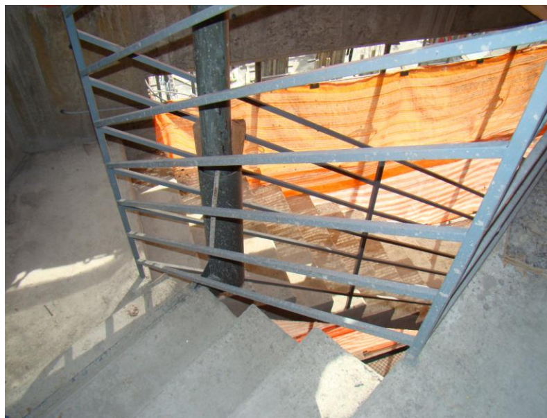
Exemplo 2 (figura 10) - Guarda-corpo da escada instalado durante a obra.
