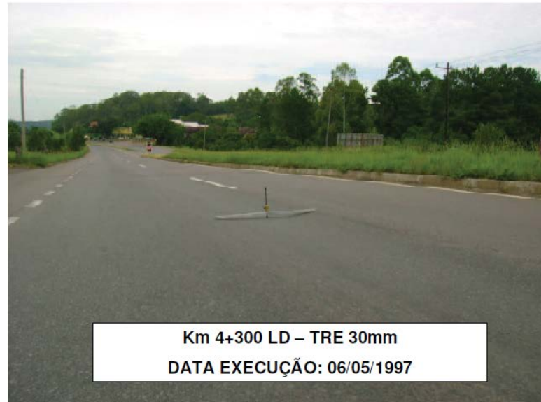
Figura 3: Identificação de afundamento em trilha de roda km 4+300 ERS-122 (DAER, 2007)
