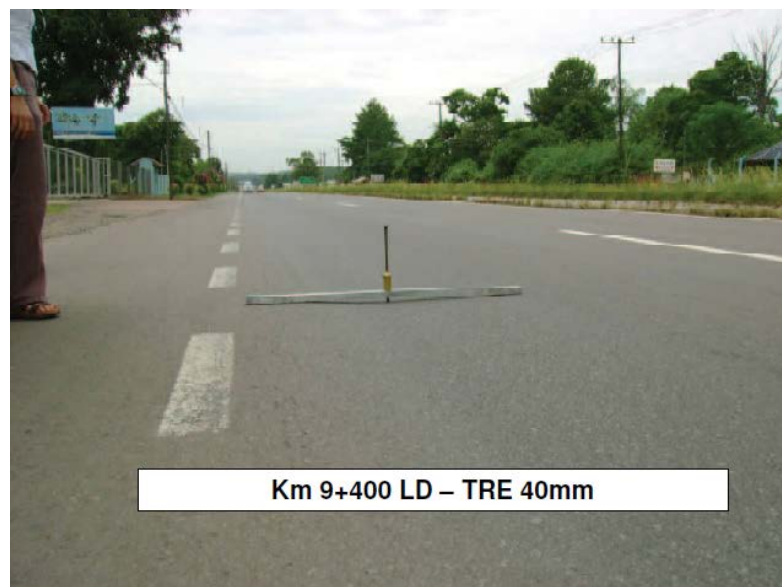
Figura 4: Identificação de afundamento em trilha de roda km 9+400 (DAER, 2007)
