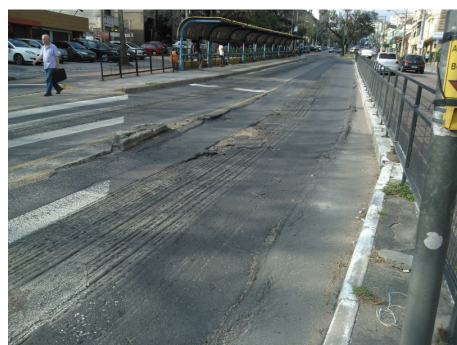
Figura 22– Avarias no pavimento das vias
