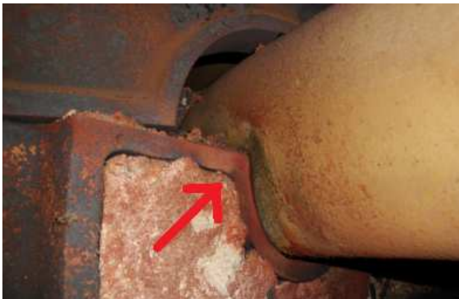
Figura 14 - Vista do espelho do lado oeste com o tubo amassado
