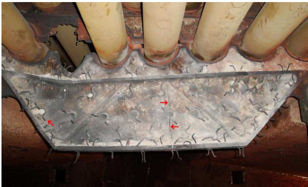
Figura 16 - Vista das trincas encontradas no módulo inferior do suporte intermediário da convecção após remoção do refratário.
