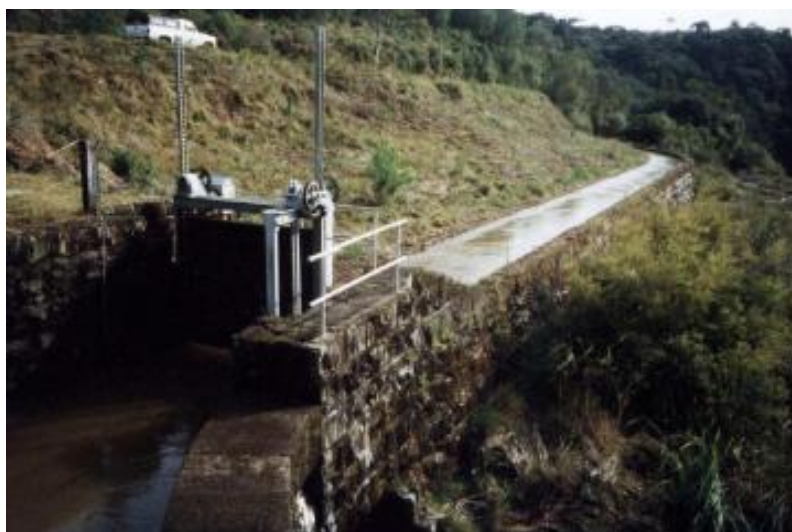
Figura 6 – Tomada d'água de superfície
