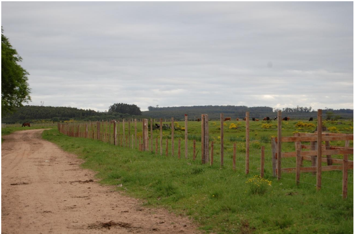
Figura 2: Delimitação da área experimental com 5,5 hectares instalada com cerca própria para ovinocultura (sete fios com tramas altas e baixas), construída em moirões de eucalipto e arame galvanizado.
