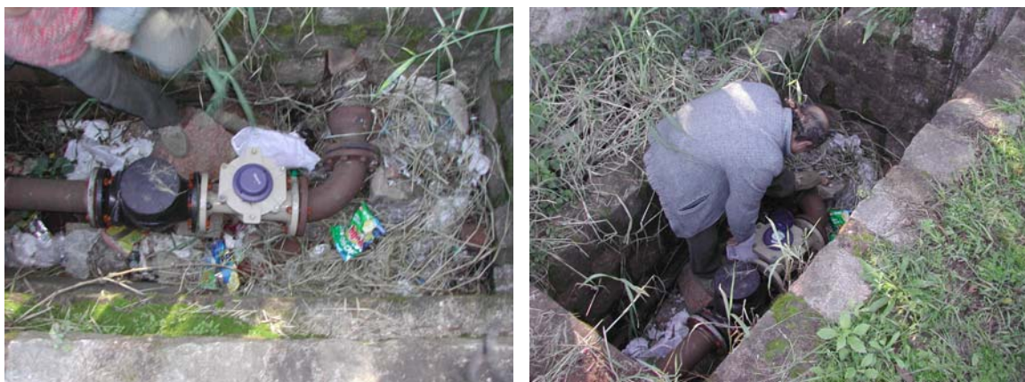
Figura 31: hidrômetro do Anel Viário do Campus do Vale
