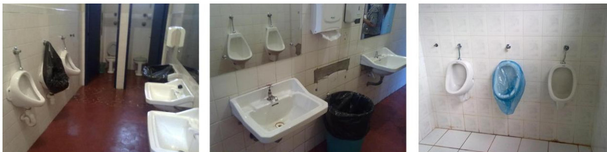
Figura 12 – Banheiro existente no Instituto de Pesquisas Hidráulicas com mau funcionamento dos aparelhos sanitários
