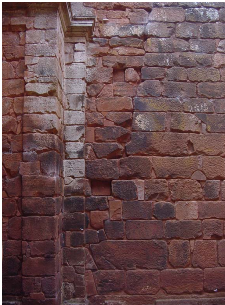
Figura 15: junta entre as duas primeiras etapas da construção da Igreja
