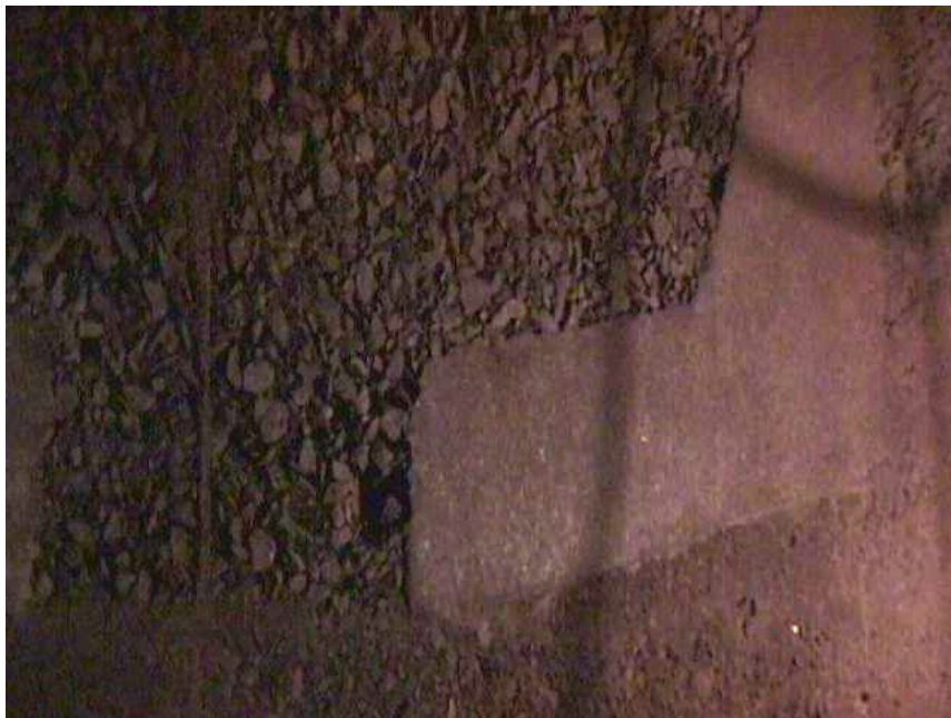
Figura 5: efeitos da abrasão no tubo de sucção da UHE Itaipú (LATORRE, 2002)
