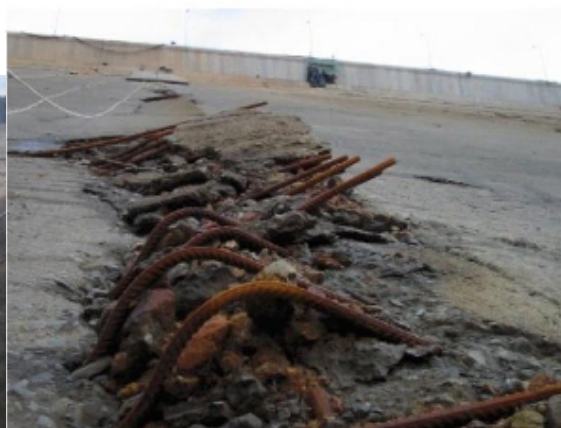
Figura 14: detalhe das trincas e flambagem das armaduras na UHE Campos Novos.
