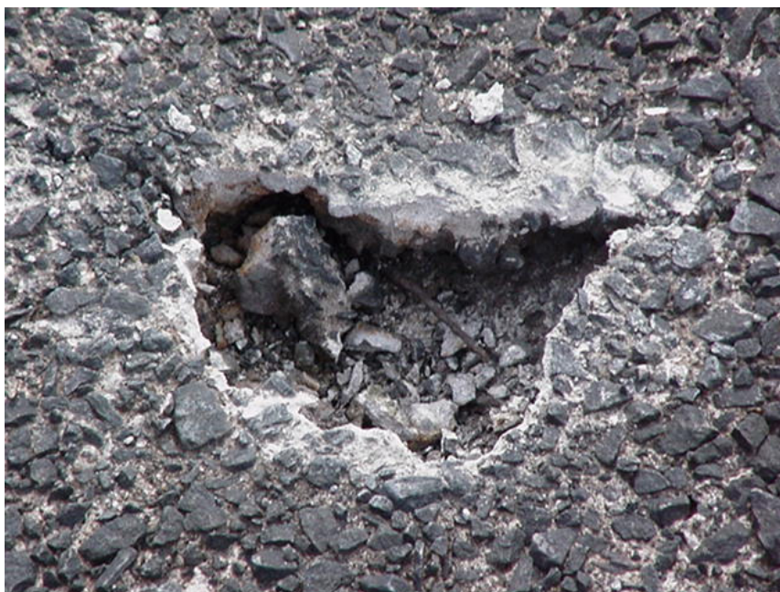
Figura 6: efeitos da cavitação no vertedouro de Itaipu (LATORRE, 2002)
