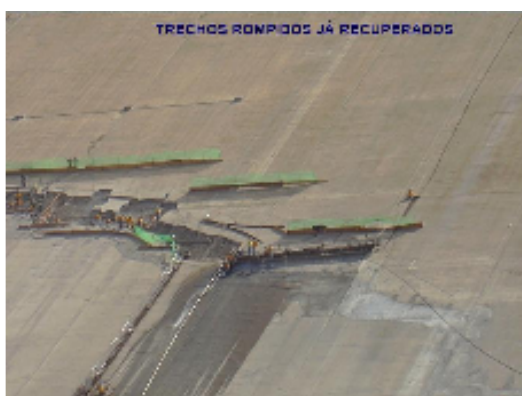
Figura 19: trechos rompidos já recuperados
