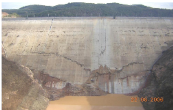
Figura 13: vista frontal das trincas ocorridas na UHE Campos Novos.
