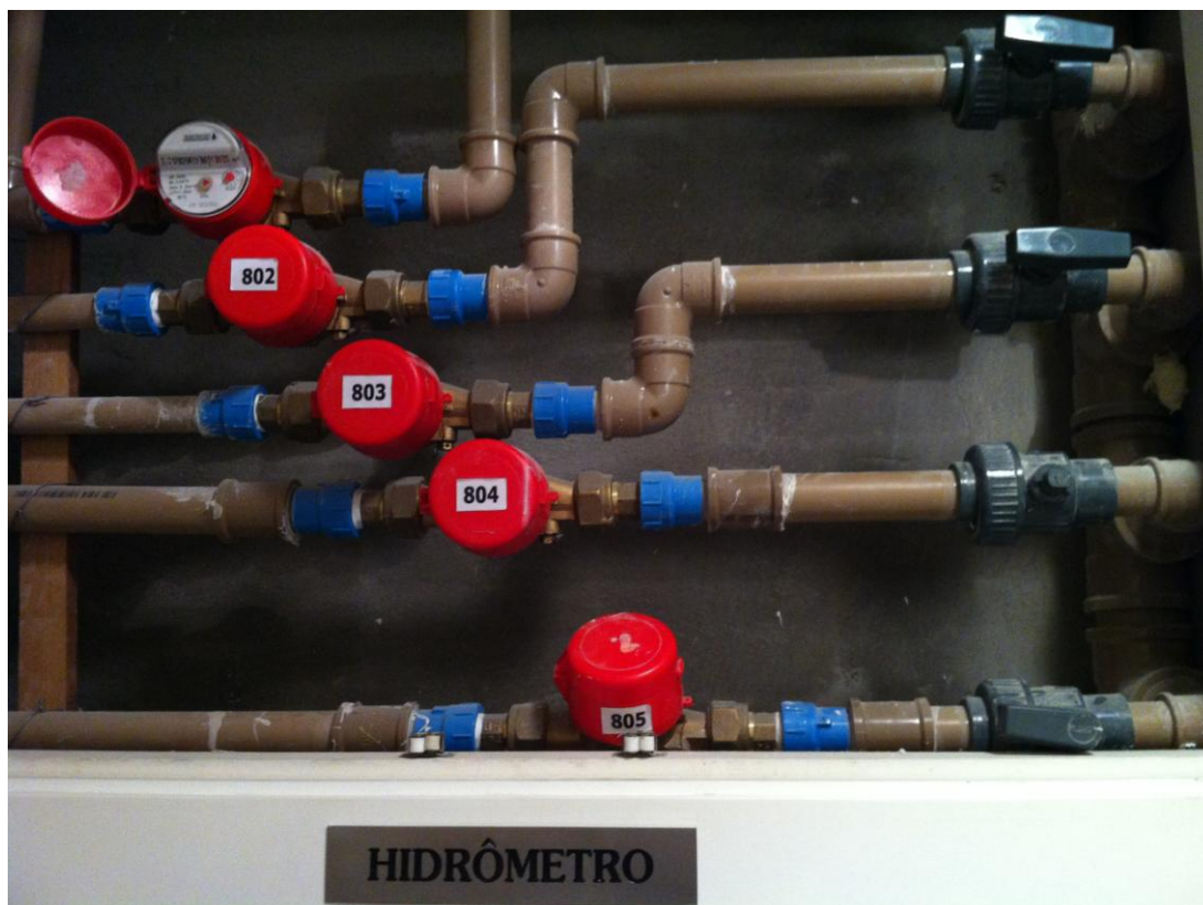
Figura 9 – Posicionamento dos hidrômetros no hall de entrada
