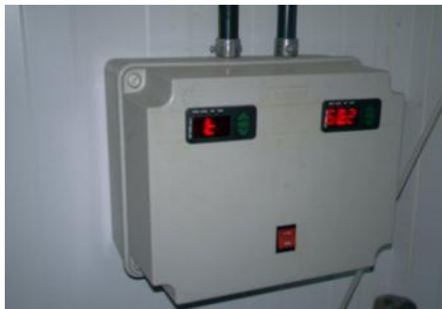
Figura 16 – Controle da temperatura e umidade relativa da câmara na 1ª fase
