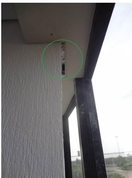
Figura 43 – Fresta ocasionada pela utilização de retalhos de placas de gesso
