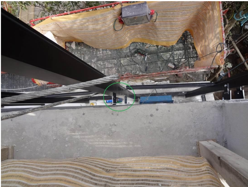
Figura 27 –Afastamento excessivo da coluna de fixação à laje
