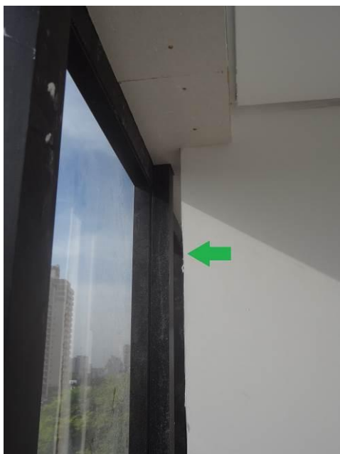
Figura 41 – Parede sem o acabamento dos perfis de alumínio
