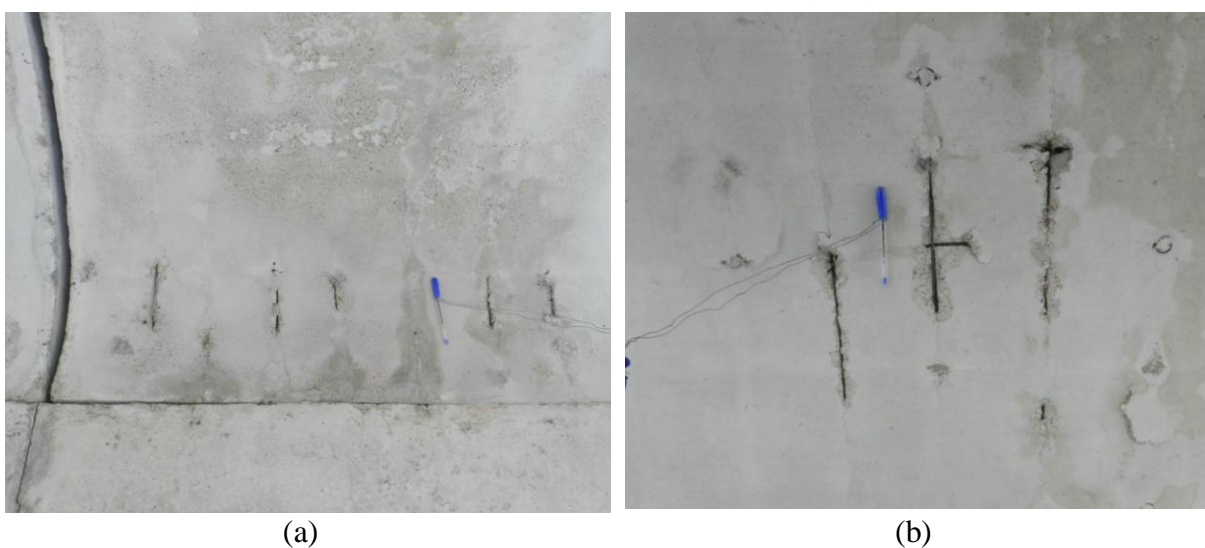
Figura 52 – (a) exposição da armadura por falta de cobrimento na cobertura 4 do módulo 6 e (b) exposição da armadura por corrosão da armadura na cobertura 3 do módulo 8
