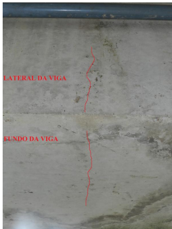
Figura 45 – Detalhe da fissura na lateral da viga esquerda do módulo 14
