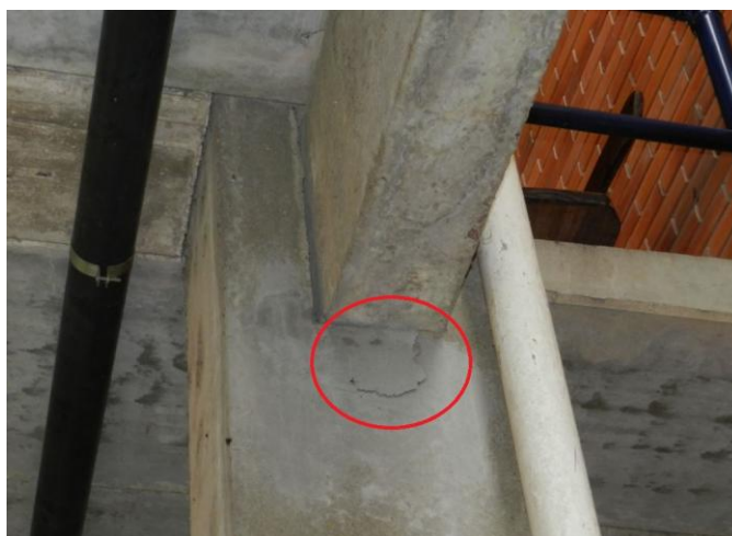
Figura 31 – Fissura localizada na região de apoio da viga no P1D do módulo 23
