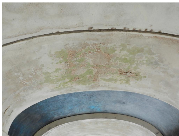
Figura 63 – Desgaste superficial na cobertura 4 do módulo 6 juntamente com a presença de processo biológico
