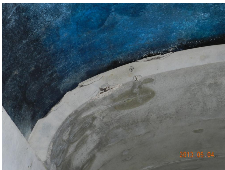
Figura 53 – Exposição da armadura na lateral da laje da cobertura 1 do módulo 12
