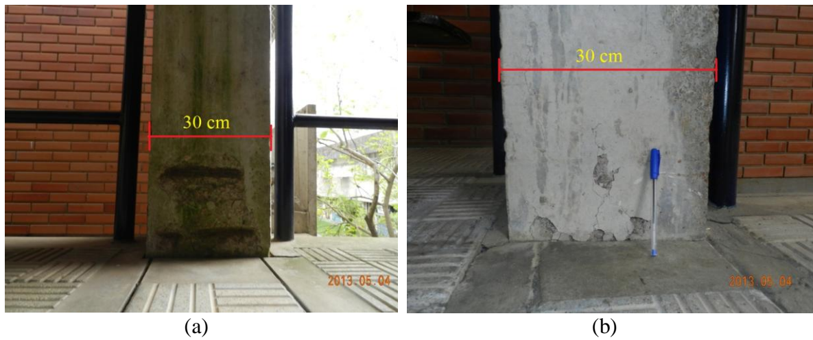
Figura 42 – (a) exposição da armadura de aço no PID do módulo 11 e (b) expulsão do cobrimento na base do P2D do módulo 22
