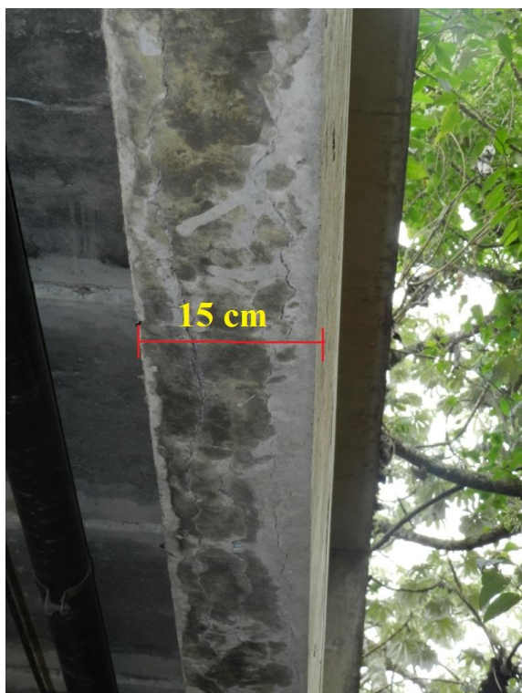
Figura 36 – Fissuras na face inferior da viga esquerda do módulo 8
