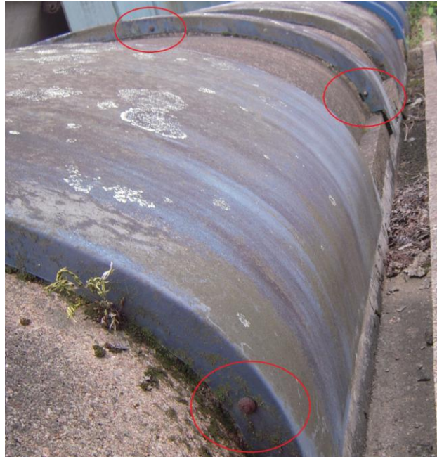
Figura 58 – Parte superior das coberturas com a posição dos parafusos
