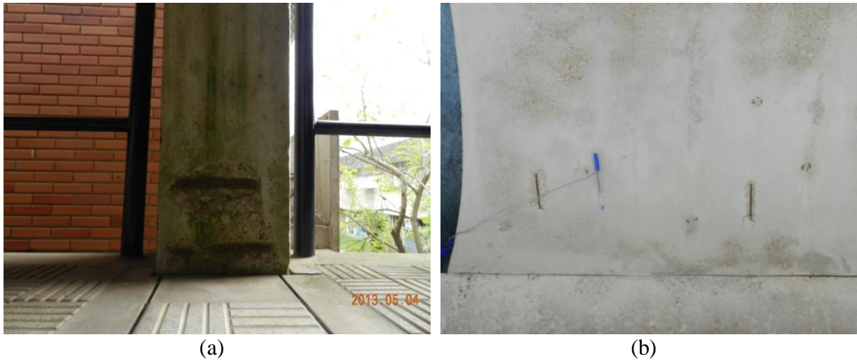
Figura 24 – (a) exposição de armadura por processo de deterioração e (b) por falta de cobrimento
