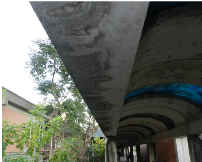
Figura 49 – Manchas de sujeira na viga esquerda do módulo 13
