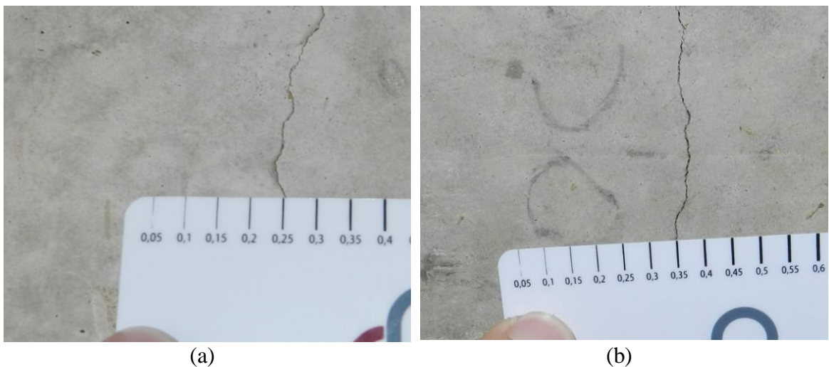
Figura 46 – (a) abertura da fissura na face lateral da viga esquerda do módulo 14 e (b) abertura na face inferior da viga esquerda do módulo 26
