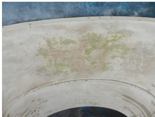
Figura 25 – Desgaste superficial de laje de cobertura
