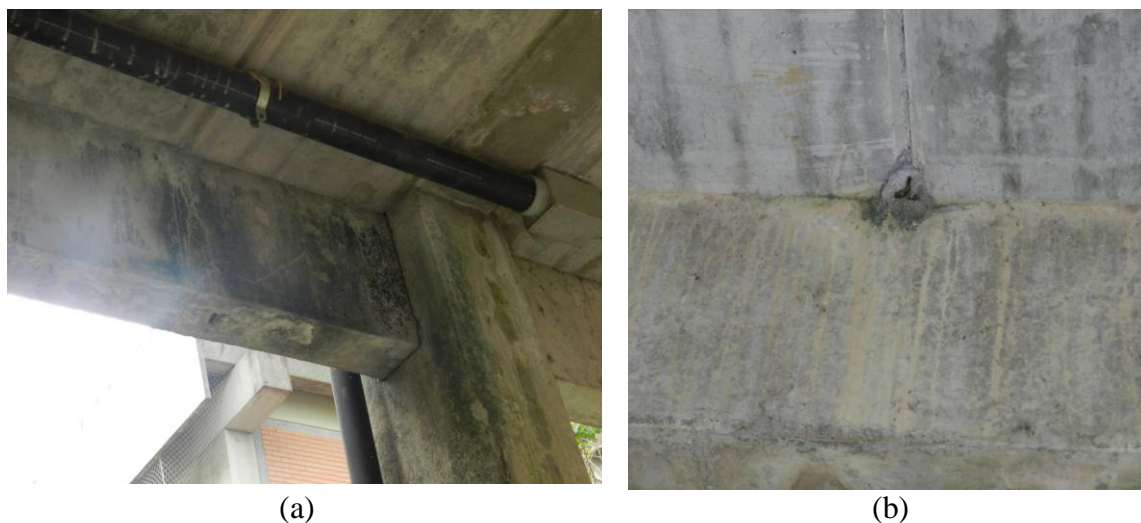
Figura 39 – (a) P2E e viga esquerda do módulo 13 com a superfície tomada por processo biológico e (b) lascamento da laje da passarela do módulo 8 com processo biológico
