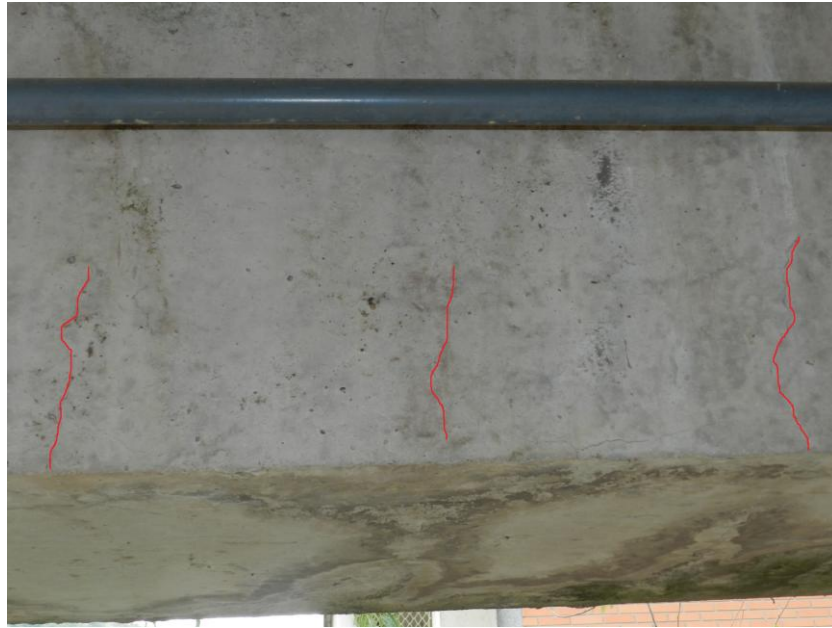
Figura 44 – Fissuras na lateral da viga esquerda do módulo 14
