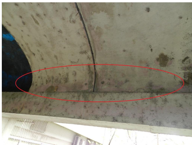
Figura 62 – Manchas rosa nas coberturas 2 e 3 do módulo 10
