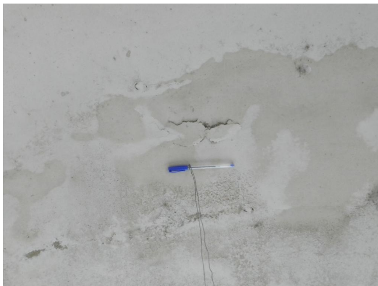
Figura 54 – Expulsão parcial do cobrimento na cobertura 4 do módulo 7
