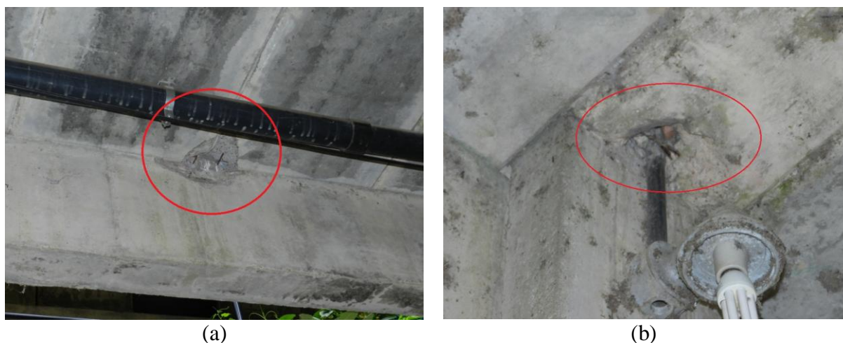
Figura 37 – (a) lascamento expondo a armadura na laje da passarela módulo 8 e (b) exposição da armadura devido à quebra da laje da passarela no módulo 23
