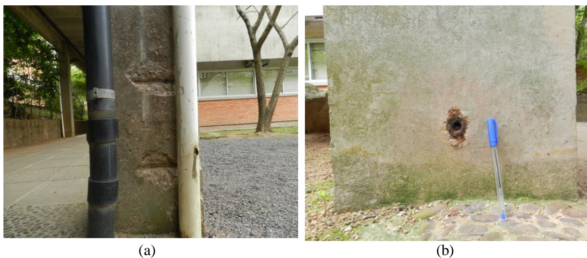
Figura 32 – (a) exposição dos estribos do P2D do módulo 9 e (b) ponto metálico corroído no P2D do módulo 21
