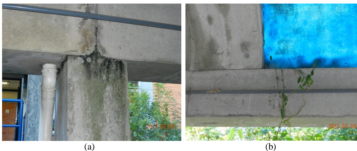
Figura 47 – (a) presença de material orgânico na junta das vigas com o P2E do módulo 19 e (b) vegetação na viga esquerda do módulo 21
