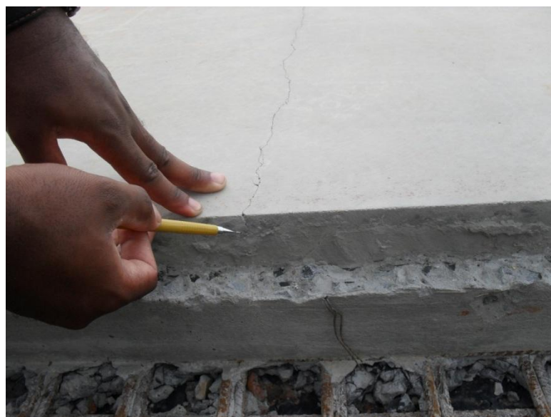
Figura 14 – Aparecimento de fissuras
