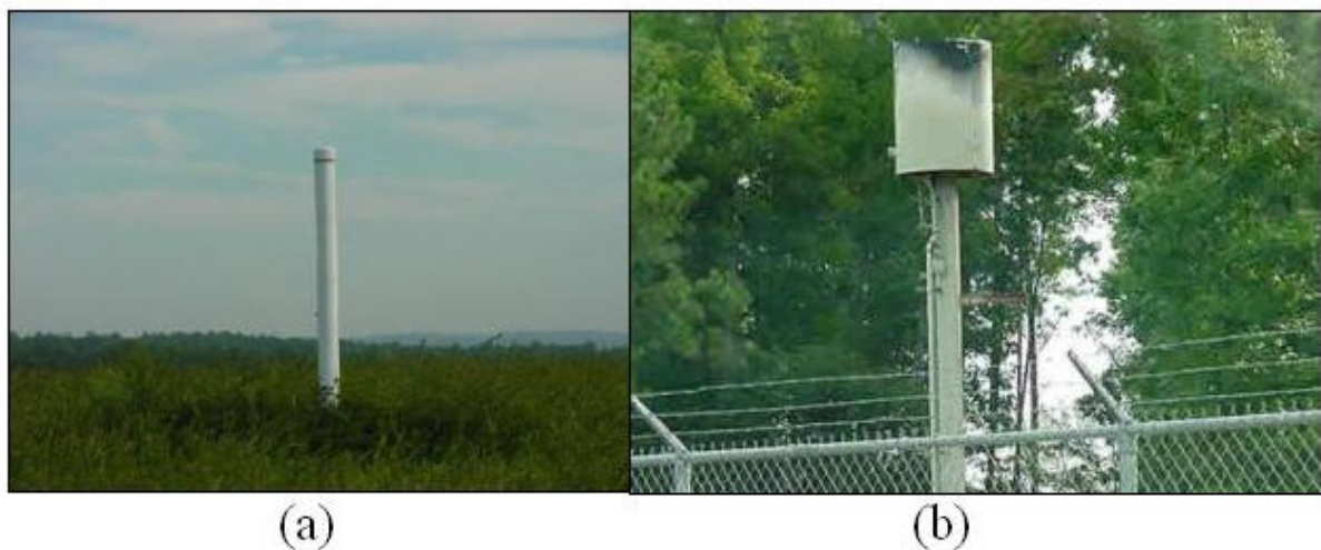
Figura 3.5: Sistema de drenagem de gás. (a) dreno de gás; (b) queimador de gás (HowStuffWorks, 2007).
