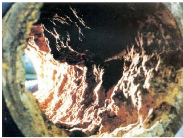
Figura 2.12: Tubulação de água de serviço apresentando severa tuberculação. (Harvey, 1993)
