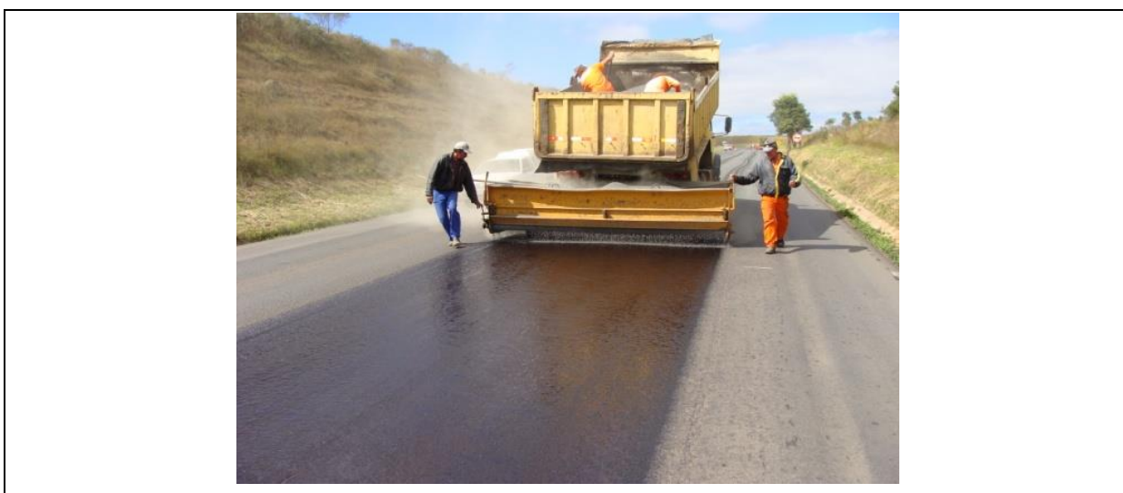
Figura 4.21 (b): Execução da camada impermeabilizante e de ligação (membrana elástica) - aplicação do agregado de graduação 4/6 mm
