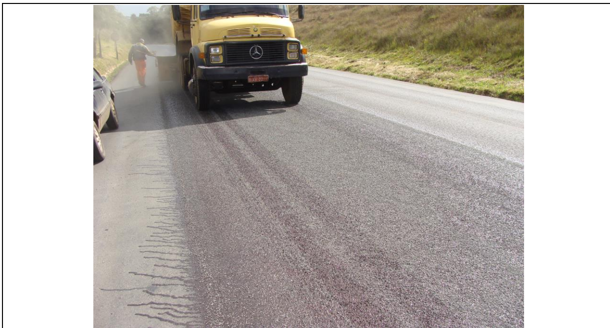
Figura 5: Execução da camada impermeabilizante e de ligação – final da aplicação do agregado 4/6 mm
