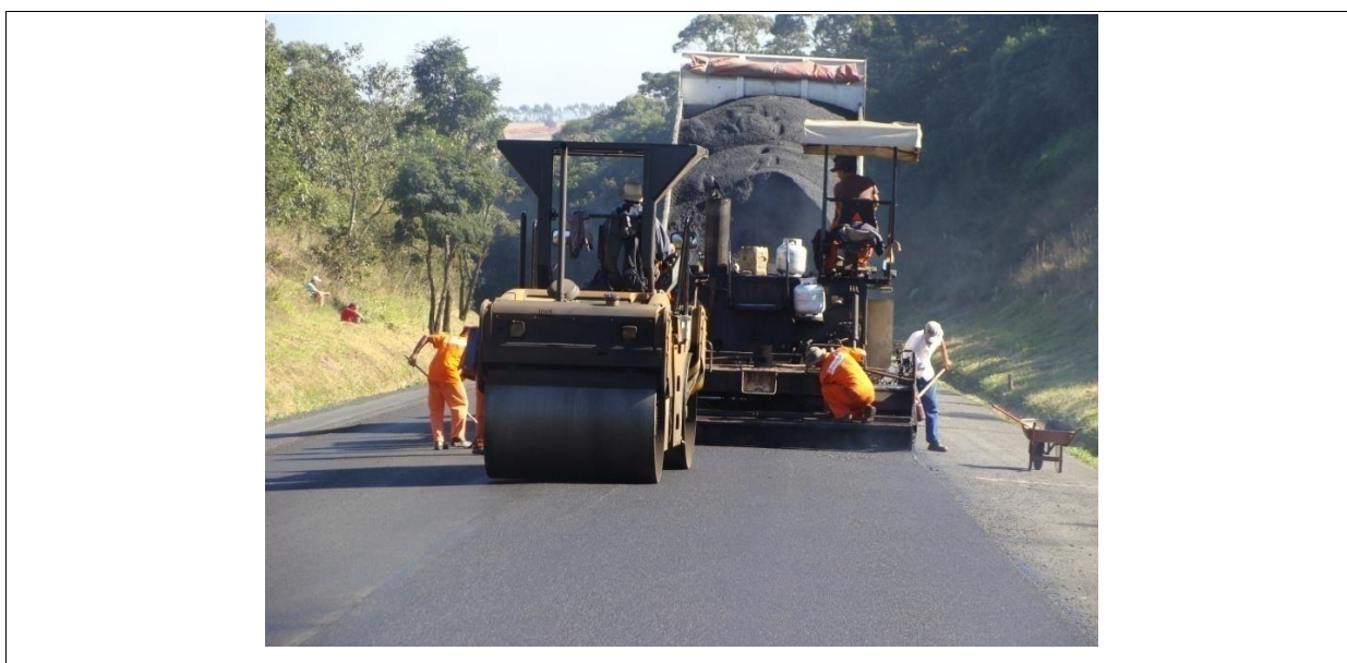
Figura 4.25: Detalhe da rolagem da mistura imediatamente atrás da vibro acabadora durante a execução do RAUD no trecho experimental
