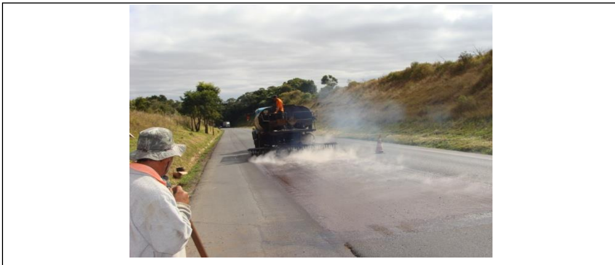
Figura 4.21 (a): Execução da camada impermeabilizante e de ligação (membrana elástica) - aplicação da emulsão elastomérica
