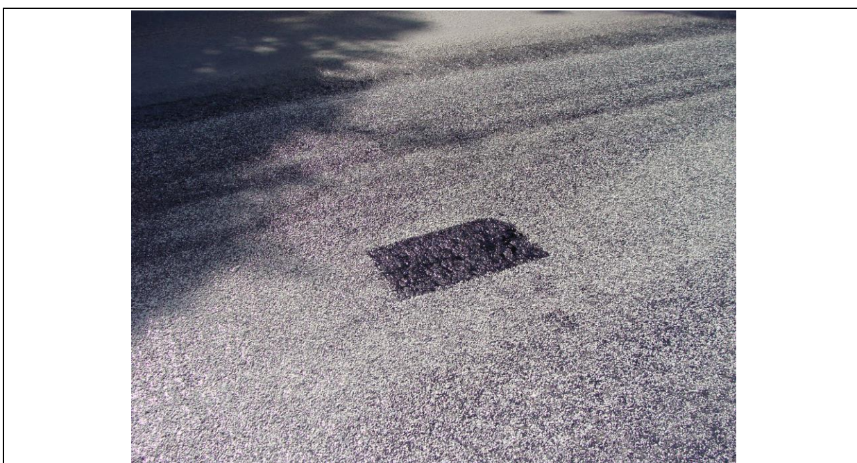
Figura 6: Execução da camada impermeabilizante e de ligação – retirada de amostra para verificação da taxa de agregado 4/6 mm
