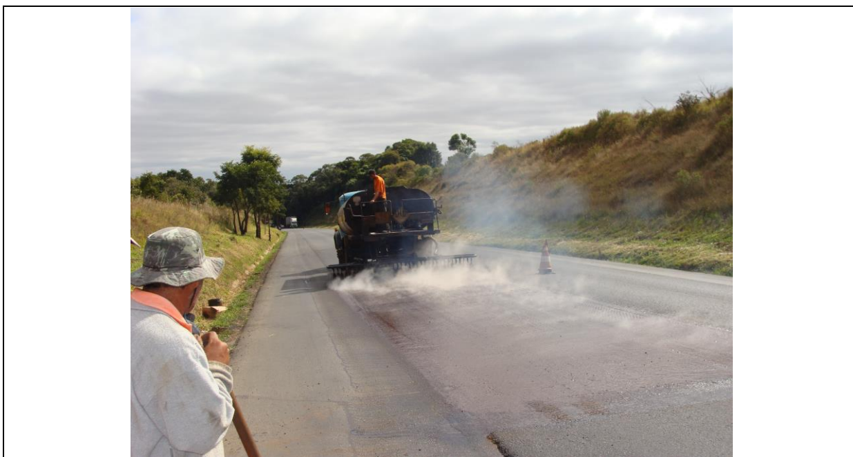
Figura 2: Execução da camada impermeabilizante e de ligação – aplicação da emulsão asfáltica elastomérica
