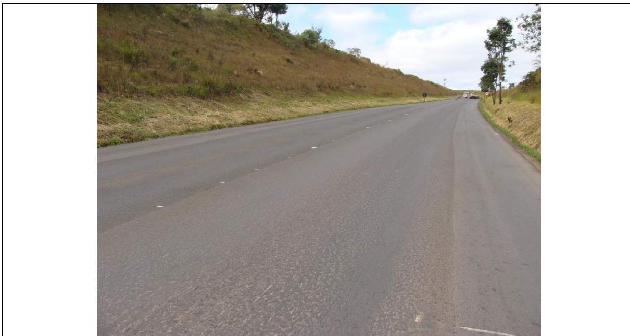
Figura 1: Rodovia PR-092 – Wenceslau Braz – Jaguariaíva – Aspecto do revestimento antigo em concreto asfáltico antes da execução do trecho experimental, em março de 2009
