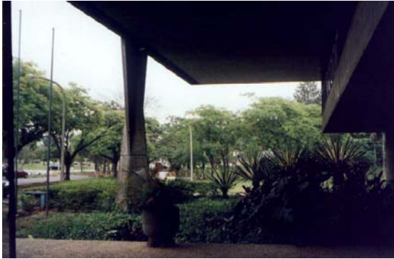
Foto tirada da rampa de acesso voltada em direção à face sudoeste.
