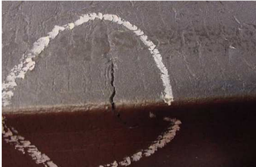
Figura 3.16. Trinca transversal de canto (Adaptado de NOGUEIRA, 2006)
