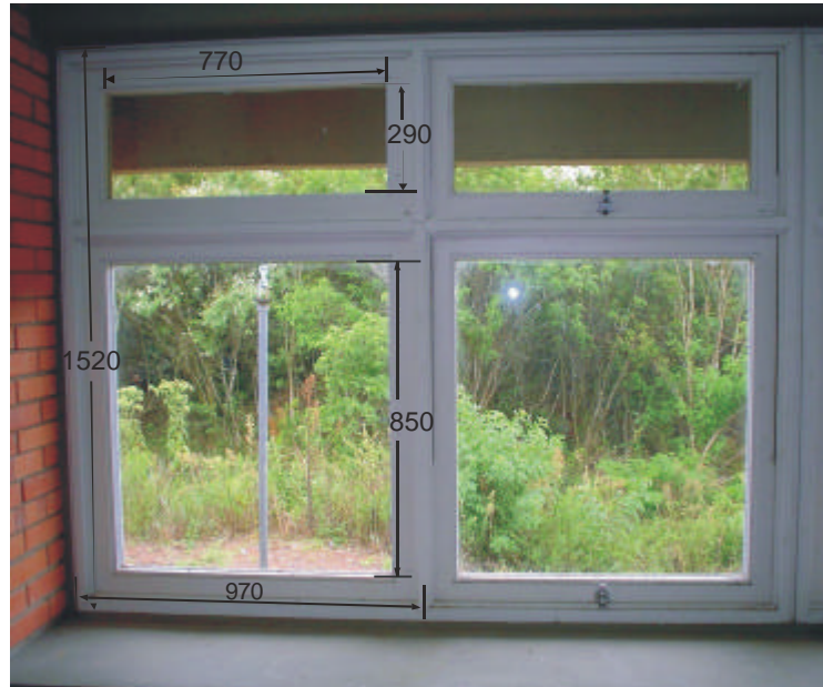
Figura 3.7 – Foto da janela da fachada norte do laboratório sobre a superfície de concreto, as distâncias estão em mm.
