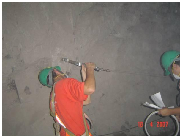
Figura 5-18: Execução de leitura de convergência no túnel de adução da UHE Castro Alves.
