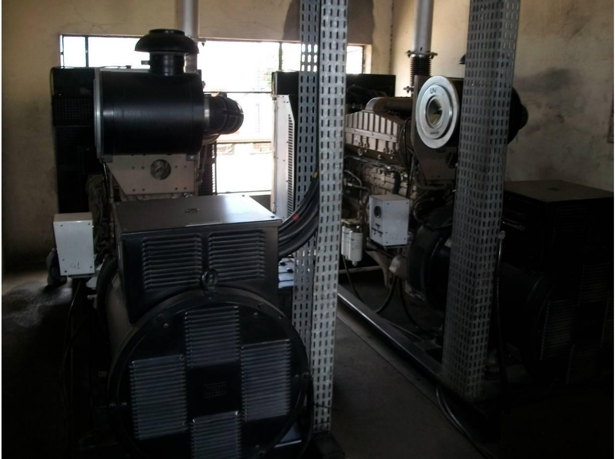
Figura 4: Geradores GG450/405 KVA Stamac – Empresa X RS
