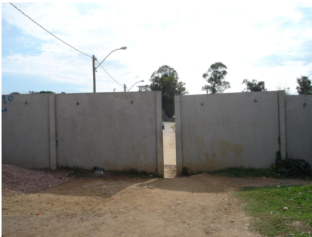
FIGURA 1: Brecha de passagem no muro que cerca o Beco.
