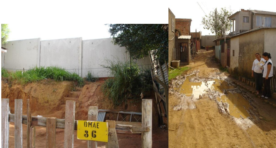
FIGURA 2: Problemas causados pela construção do muro.
