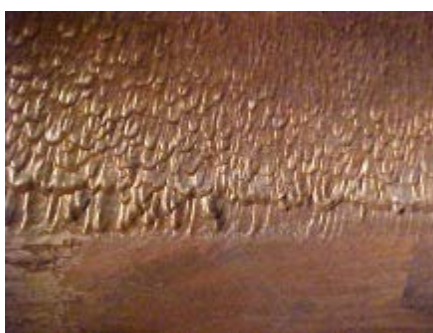
Figura 5: aspecto do efeito da erosão e corrosão no casco do permutador.
