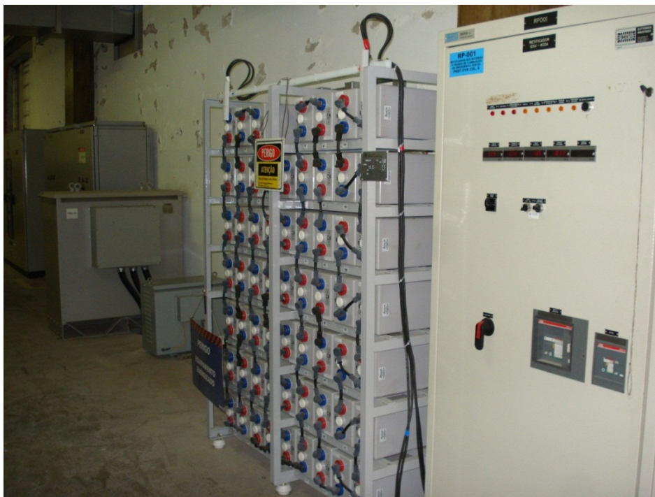
Figura 10 Banco de baterias localizado na subestação do estudo do caso (SE-51)
