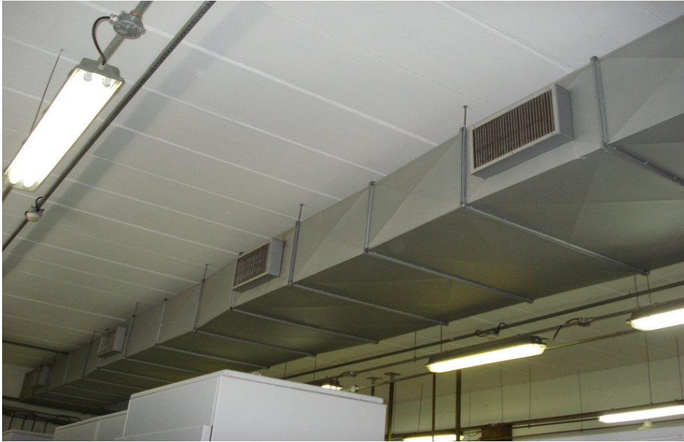
Figura 12 Duto de ar central do sistema de ventilação da subestação
