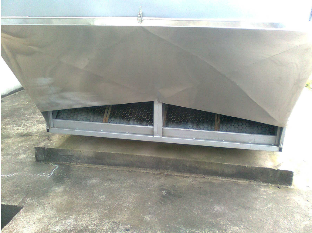
Figura 13 Sucção de ar do ventilador
