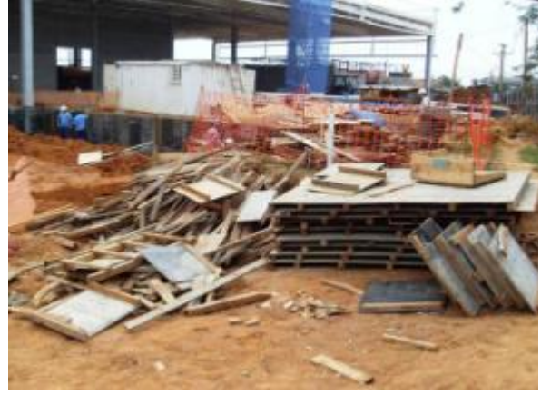
Figura 7 – Madeiras já utilizadas depositadas em meio ao ambiente de trabalho na obra B
