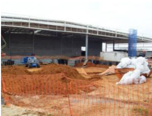
Figura 24 – Cerca plastificada vazada, permitindo total visualização dos ambientes e das atividades na obra B
