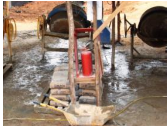
Figura 9 – Betoneiras em ambiente com excessiva umidade na obra B
