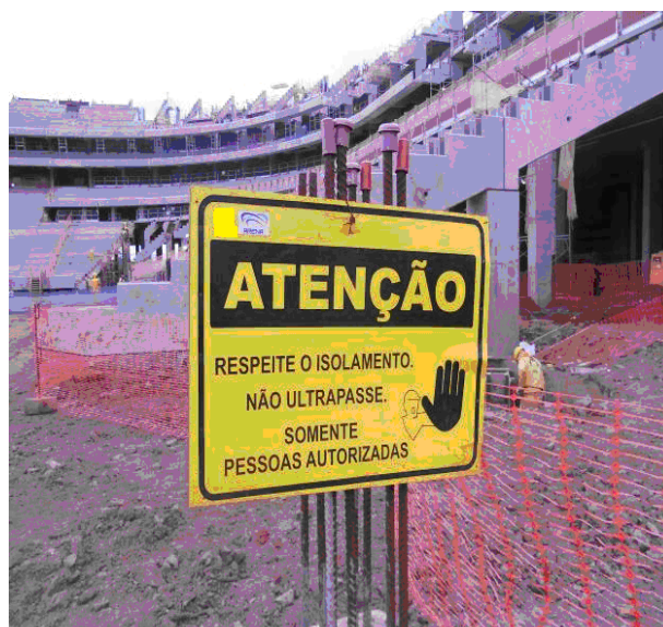
Figura 104 – Advertência quanto ao isolamento de local de trabalho no canteiro A
