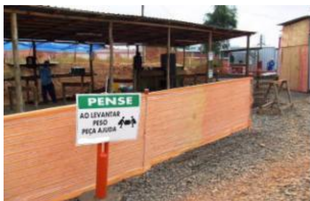
Figura 100 – Aviso aos trabalhadores do procedimento adequado ao levantar peso no canteiro B
