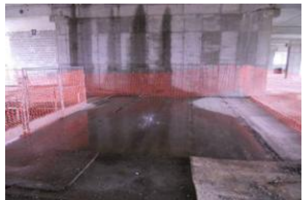
Figura 21 – Ponto de vazamento em ambiente produtivo interno na obra A
