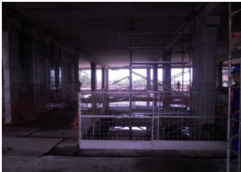
Figura 64 – Ambiente interno mal iluminado na obra A
