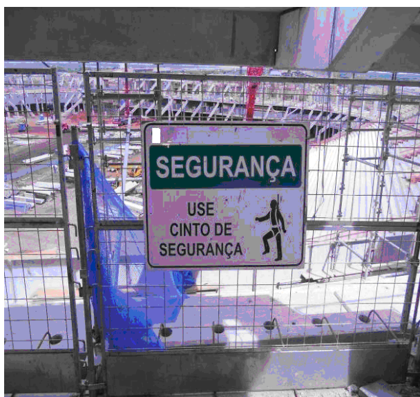
Figura 103 – Aviso da obrigatoriedade do uso do cinto de segurança no canteiro A
