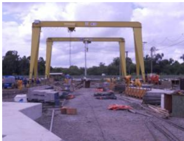
Figura 55 – Vista frontal do pórtico rolante, no canteiro A
