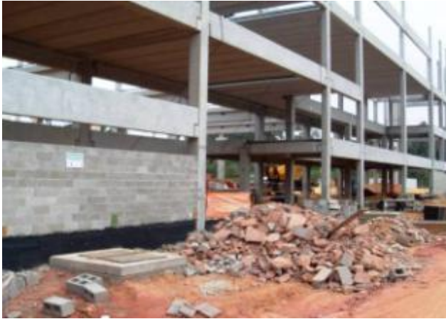
Figura 18 – Ilhas de blocos e restos de construção sem isolamento no canteiro B
