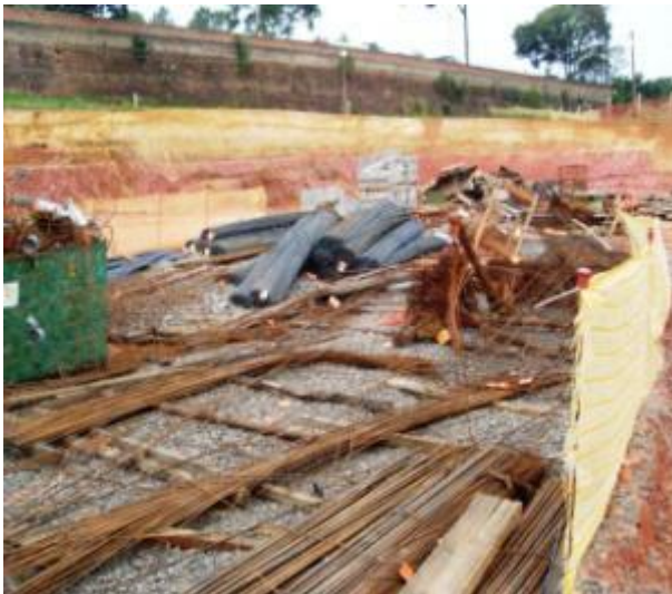
Figura 48 – Estoque de armaduras sem qualquer padrão e organização no canteiro B
