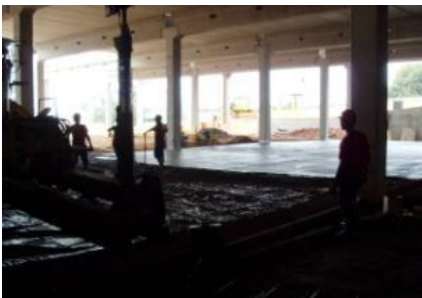
Figura 67 – Atividade sendo realizada em local pouco iluminado no canteiro B
