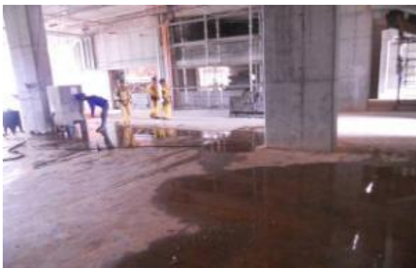
Figura 20 – Local de trabalho sujo e mal iluminado na obra A
