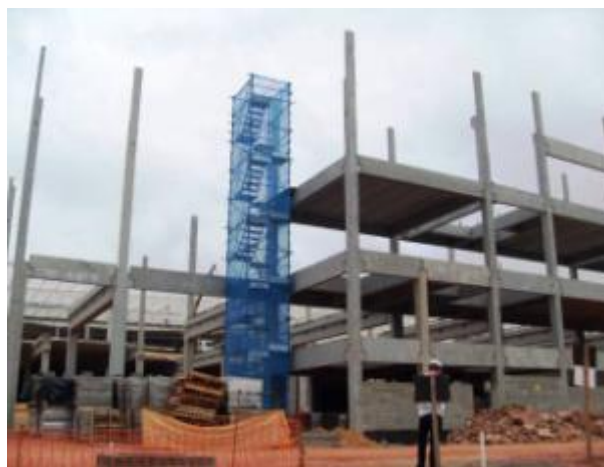
Figura 35 – Cerca delimitando e protegendo o espaço das escadarias provisórias na obra B
