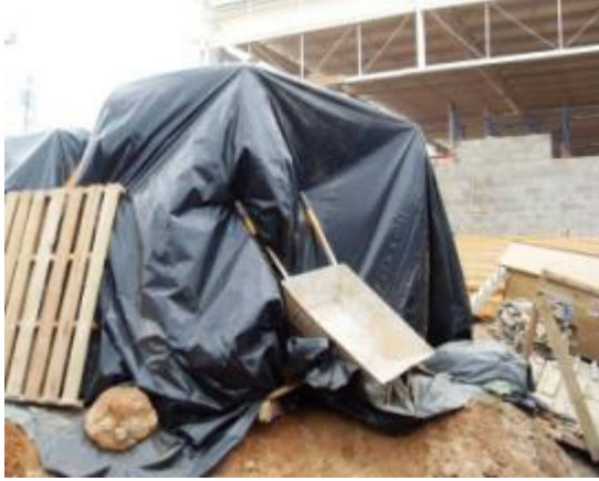
Figura 6 – Entulho de materiais utilizados encobertos por lona plástica, no canteiro B
