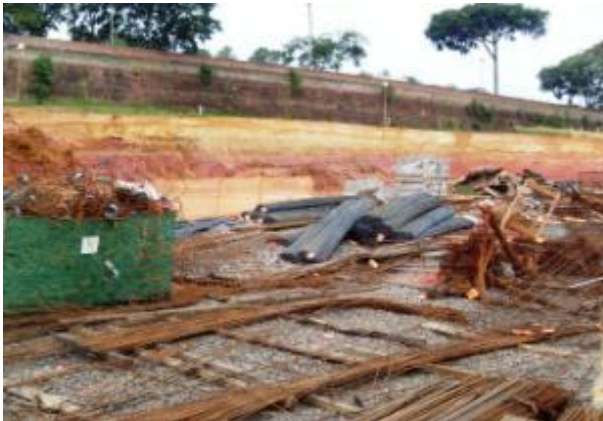
Figura 8 – Estoque das armaduras de forma desorganizada no canteiro B
