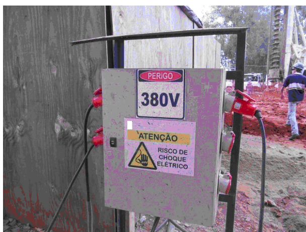
Figura 105 – Aviso de atenção quanto ao risco de choque elétrico no canteiro B
