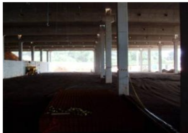
Figura 68 – Ambiente interno à obra B mal iluminado
