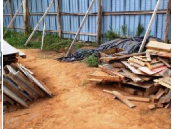
Figura 19 – Entulhos de madeira utilizada em meio à circulação de pedestres na obra B
