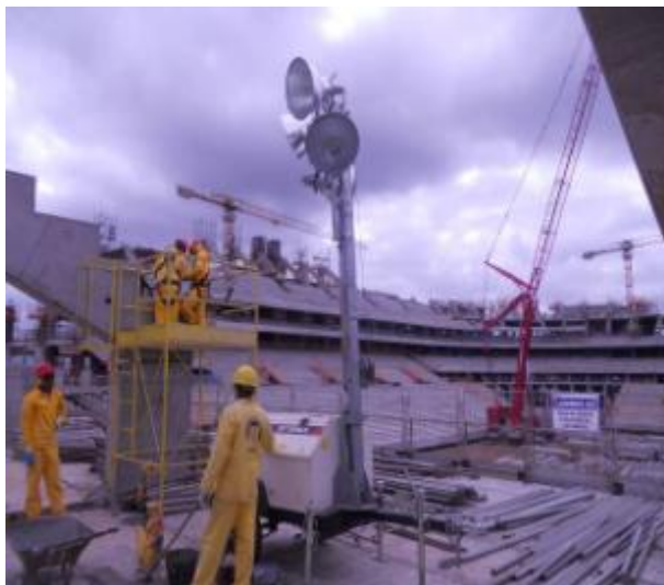
Figura 69 – Refletor posicionado na parte interna do estádio da obra A
