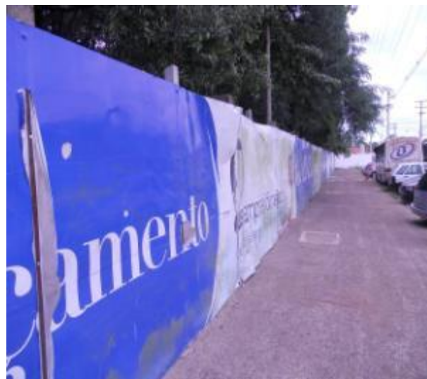
Figura 72 – Detalhe das condições precárias do tapume em frente à obra A
