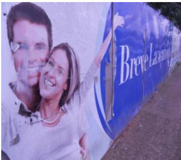
Figura 71 – Tapume principal mal conservado do canteiro A
