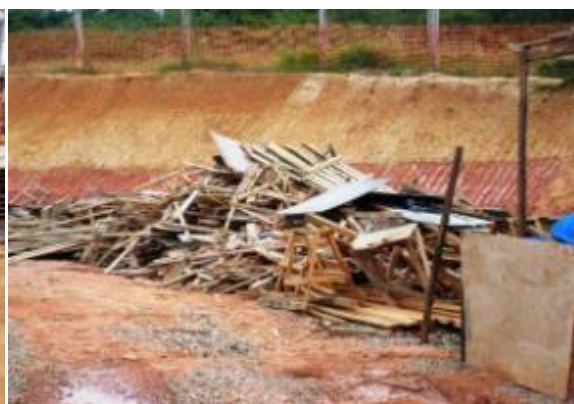
Figura 17 – Deposição de materiais utilizados sem isolamento no canteiro B
