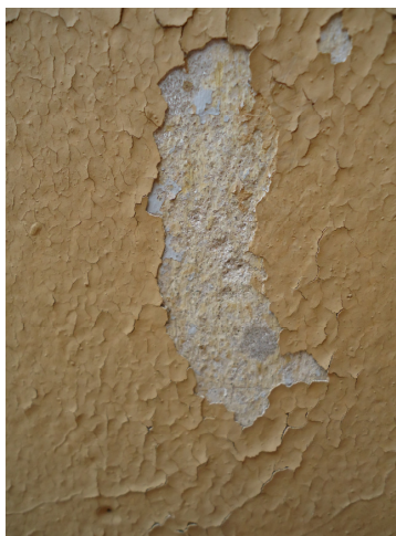
Figura 16 – Descascamento do revestimento
