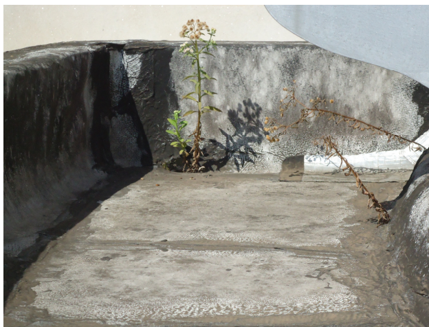
Figura 26 – Presença de vegetação acima da cobertura da escadaria
