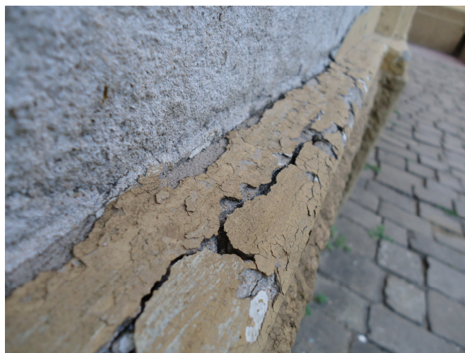
Figura 20– Fissura acima de reentrância da fachada
