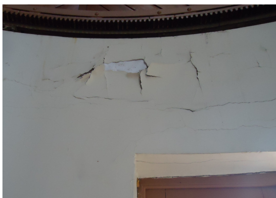
Figura 33 – Descascamento acentuado do revestimento acima da porta de acesso ao terraço da cobertura
