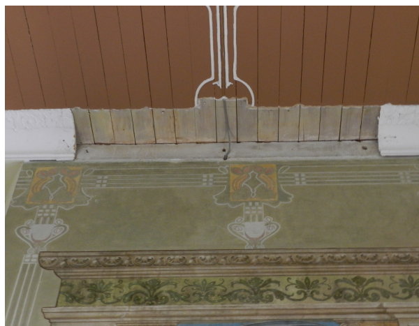
Figura 37 – Destacamento na moldura de gesso
