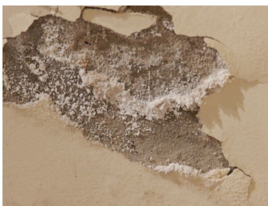
Figura 38 – Mancha de eflorescência em ponto de descolamento do revestimento
