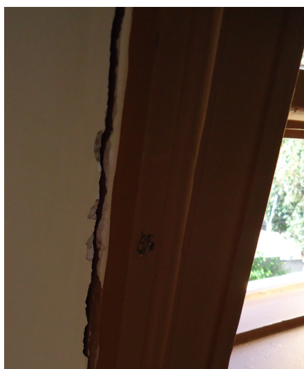
Figura 34 – Fissura na lateral de esquadria do terceiro pavimento
