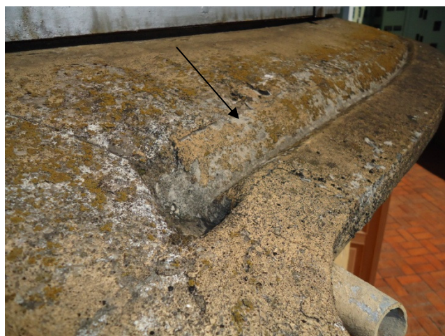
Figura 15 – Abrasão do revestimento na calha da cobertura
