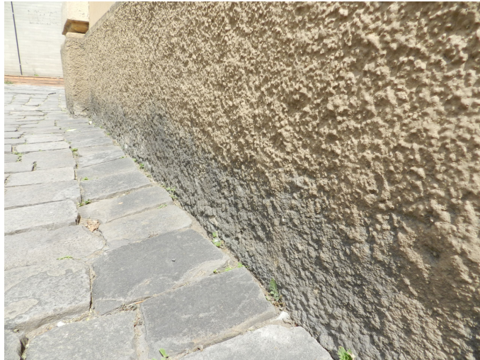
Figura 29 – Mancha escura na base da parede da fachada norte
