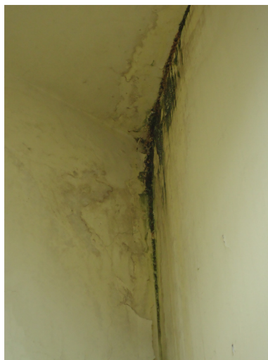
Figura 39 – Mancha esverdeada no canto do teto da escadaria que leva à cobertura
