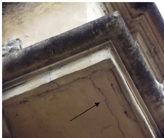
Figura 22 – Fissuração abaixo da moldura da fachada entre o terceiro pavimento e o terraço de cobertura
