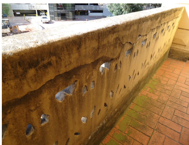
Figura 35 – Fissuração no guarda-corpo da sacada
