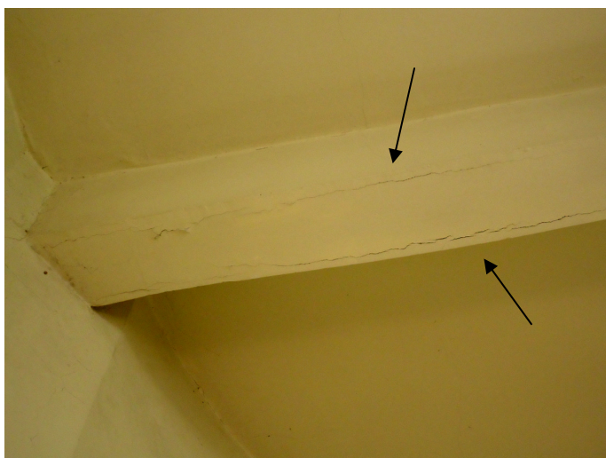
Figura 36 – Fissuras horizontais próximas às arestas na parte inferior da viga no terceiro pavimento
