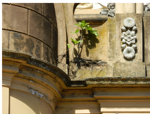
Figura 25 – Presença de vegetação junto ao frontão da fachada oeste
