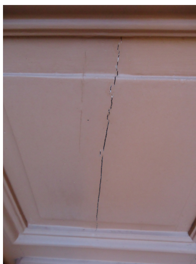
Figura 23 – Fissura na porta de madeira da entrada principal
