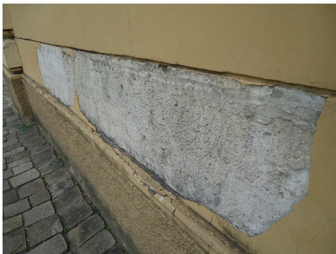
Figura 27 – Destacamento do reboco
