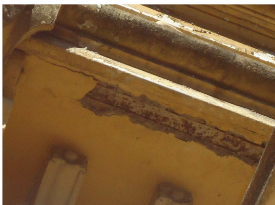
Figura 28 – Destacamento do reboco abaixo da moldura entre o terceiro pavimento e a cobertura
