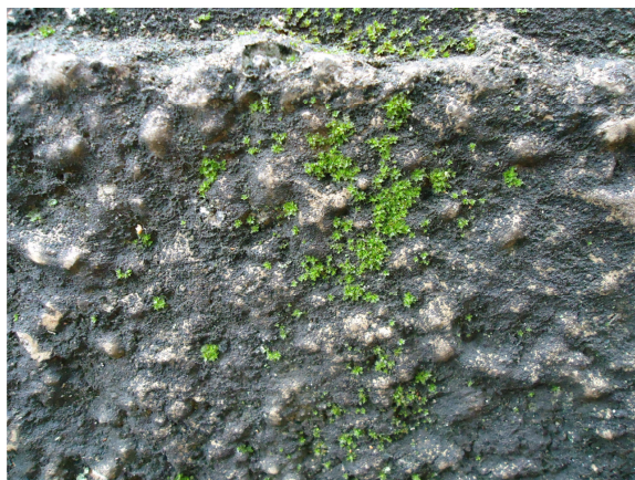
Figura 24 – Presença de limo na base da parede da fachada sul
