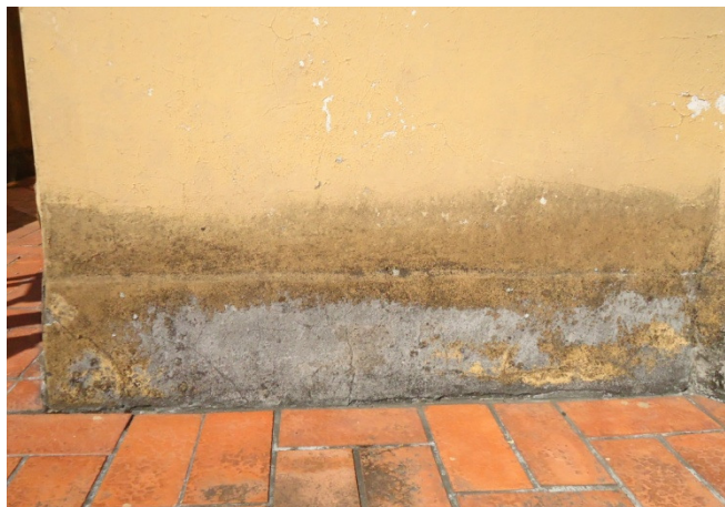
Figura 14 – Abrasão do revestimento na base da fachada da cobertura
