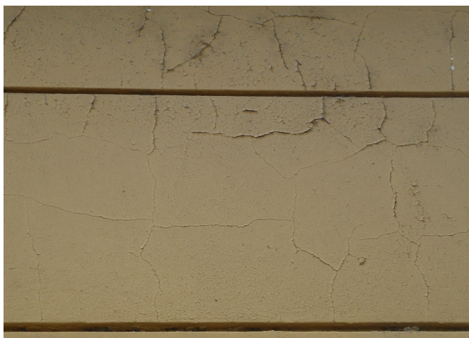
Figura 18 – Fissuras mapeadas no revestimento
