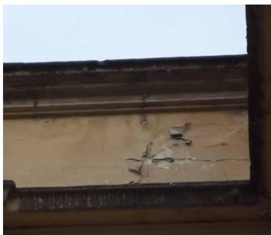
Figura 17 – Descolamento e presença de bolhas em platibanda
