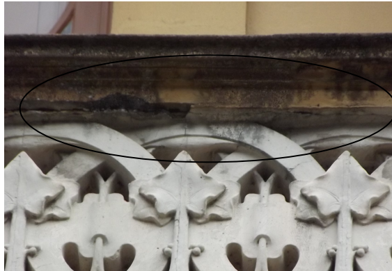
Figura 21 – Fissuração na sacada norte
