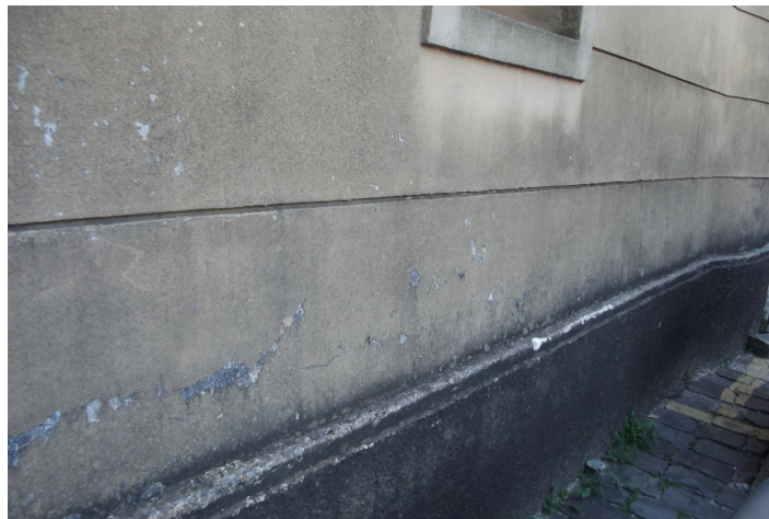
Figura 30 – Mancha escura na base da parede da fachada sul
