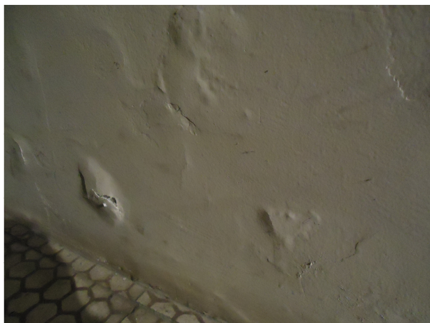
Figura 32 – Presença de bolhas na base da parede do pavimento térreo
