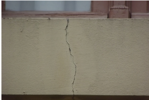
Figura 19 – Fissura na moldura da janela
