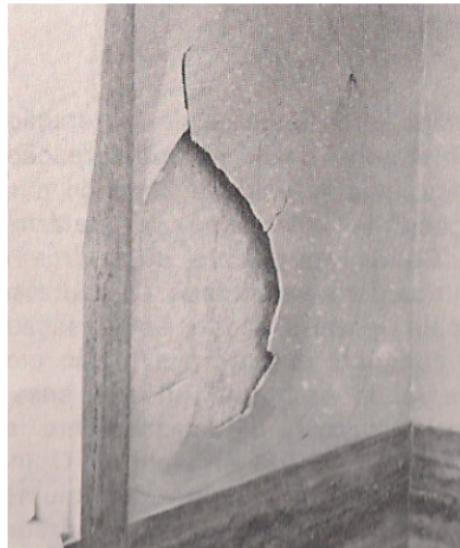
Figura 5 – Destacamento de revestimento
