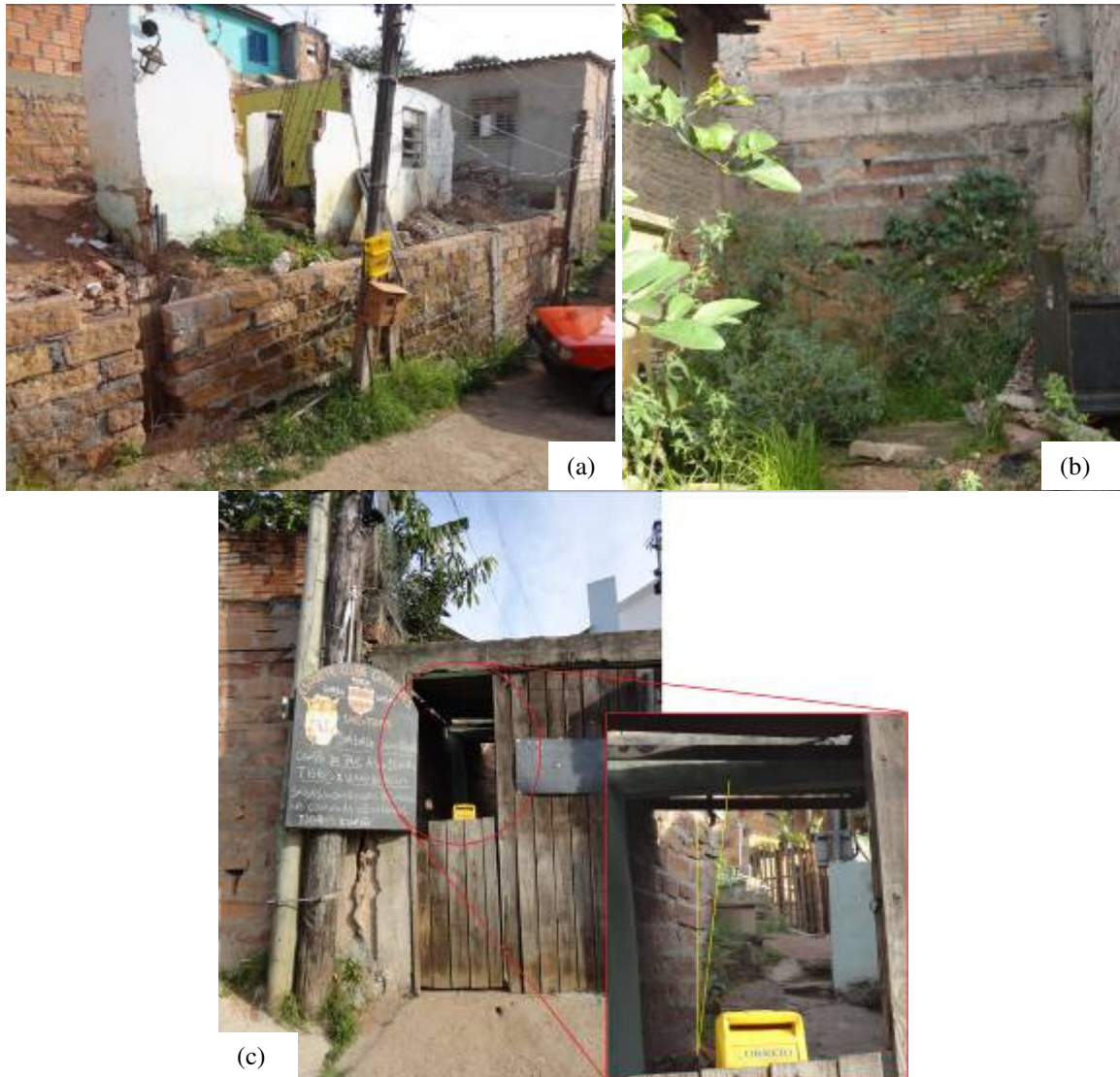
Figura 26 – (a) muro em fase de execução, (b) muro com fundação exposta e (c) muro com inclinação negativa
