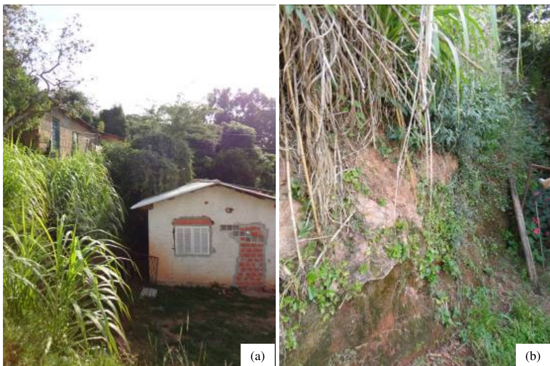
Figura 18 –(a) casas muito próximas a taludes verticais e (b) material constituinte do corte
