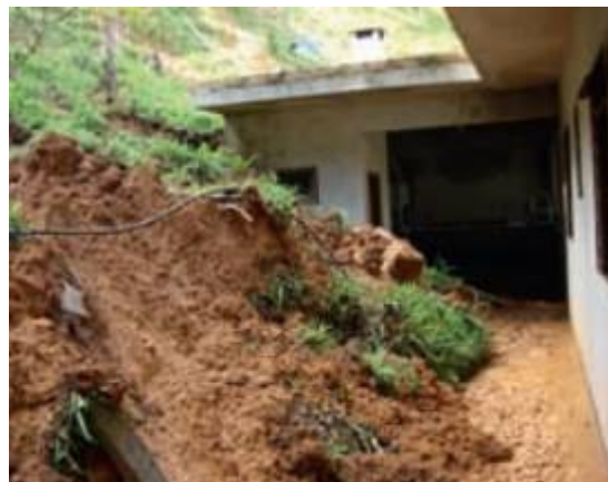
Figura 10 – Moradia muito próxima à talude de corte
