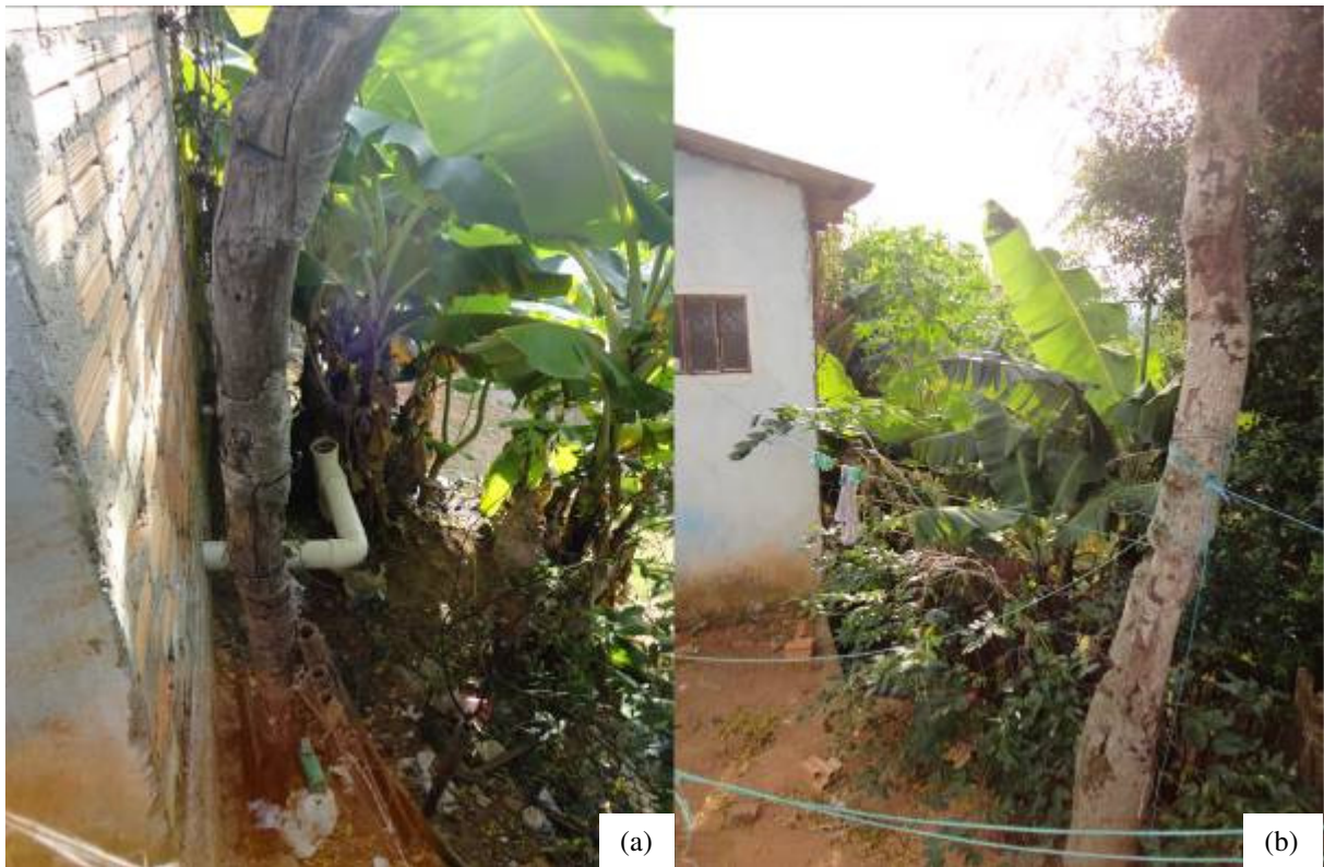
Figura 24 – (a) taludes inclinados com tubulação rompida e (b) bananeiras no setor 3
