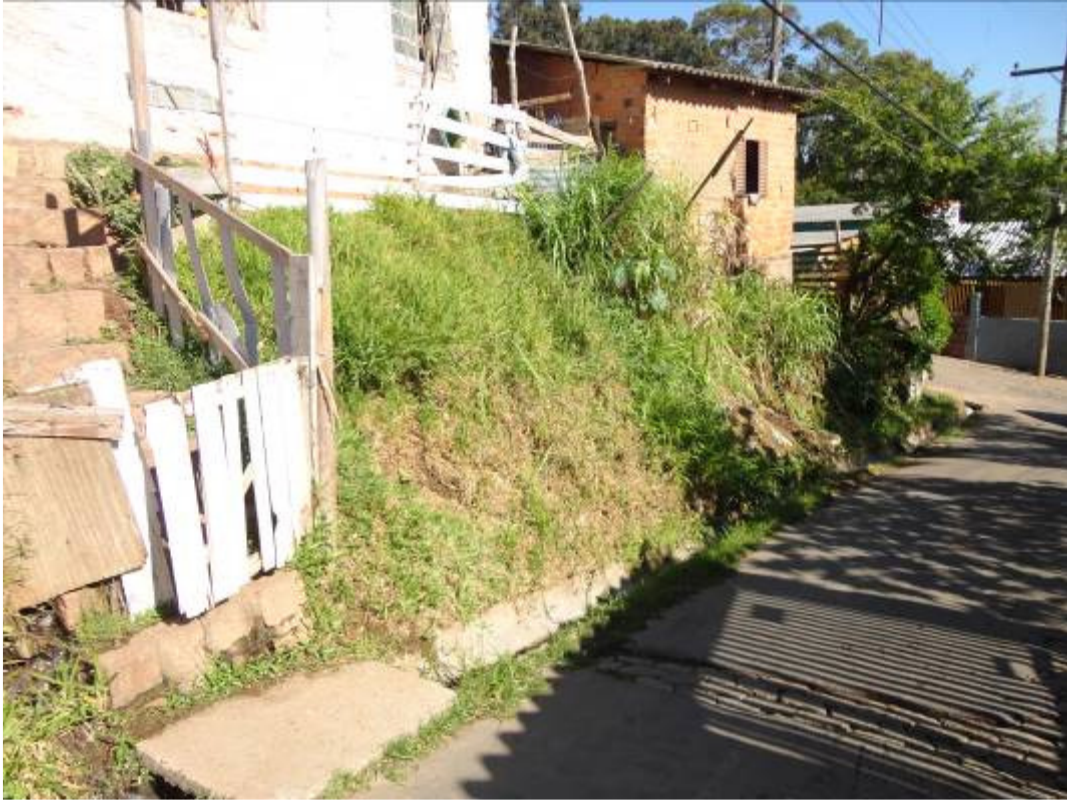
Figura 22 – Taludes excessivamente inclinados junto ao acesso
