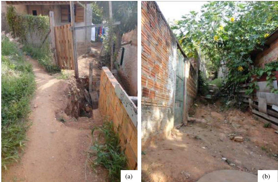
Figura 25 – (a) cortes realizados de maneira irresponsável e (b) acessos erodidos e com lixo lançado
