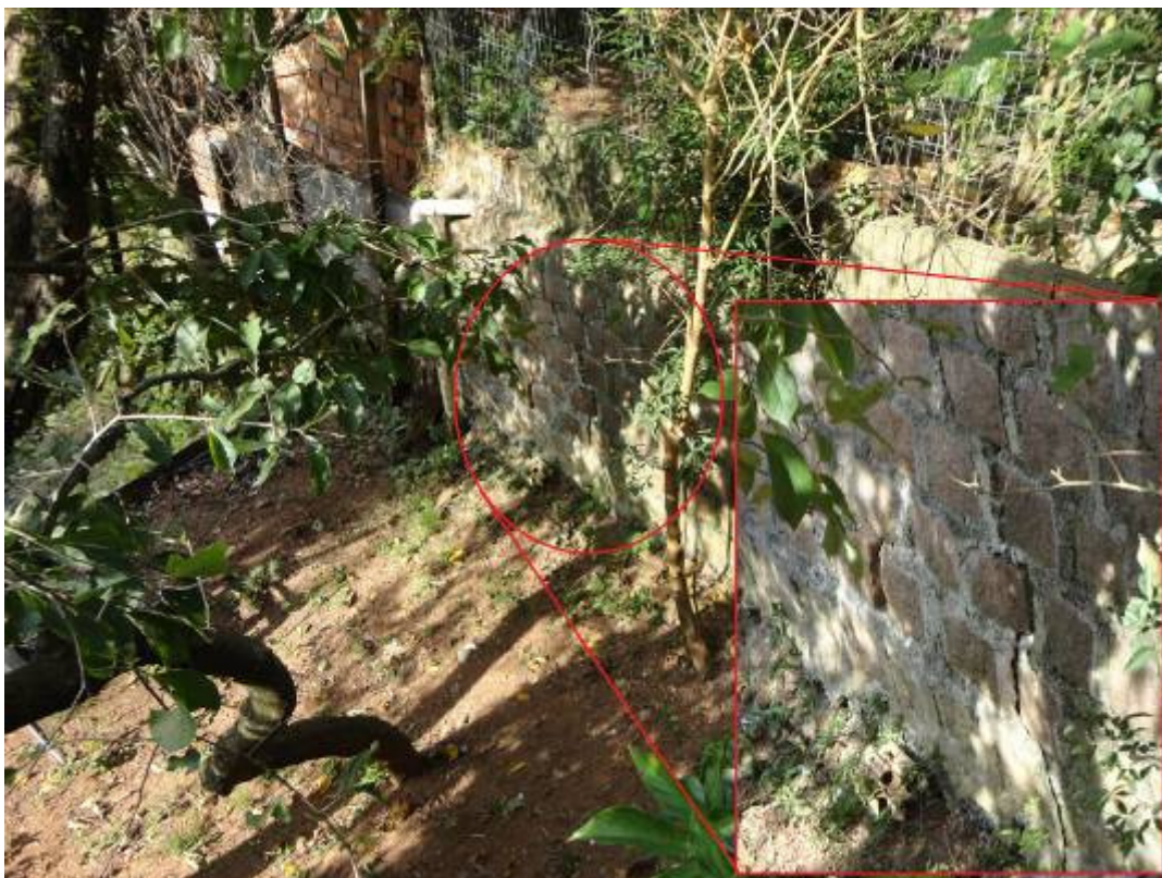
Figura 20 – Trinca em muro existente
