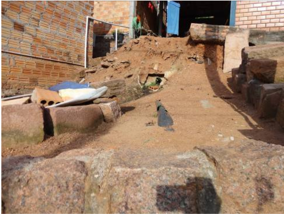
Figura 21 – Erosão devido ao rompimento de tubulação
