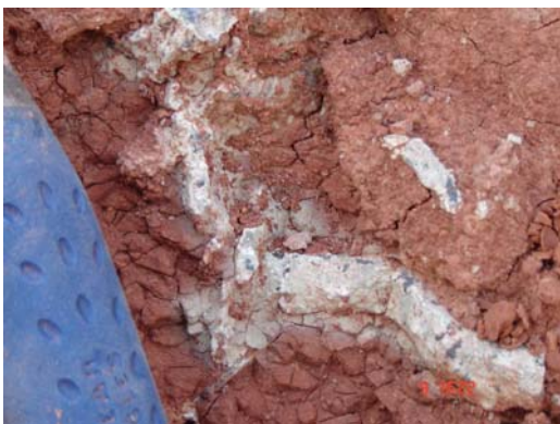
Figura 22. Carbonatação de fendas.
