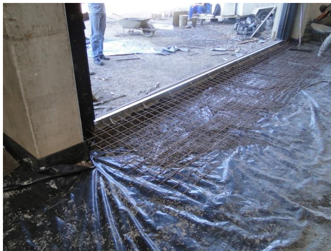
Figura 20 – Utilização de tela nas áreas de acesso da obra A
