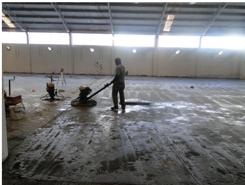
Figura 28 – Acabamento insuficiente na obra B.
