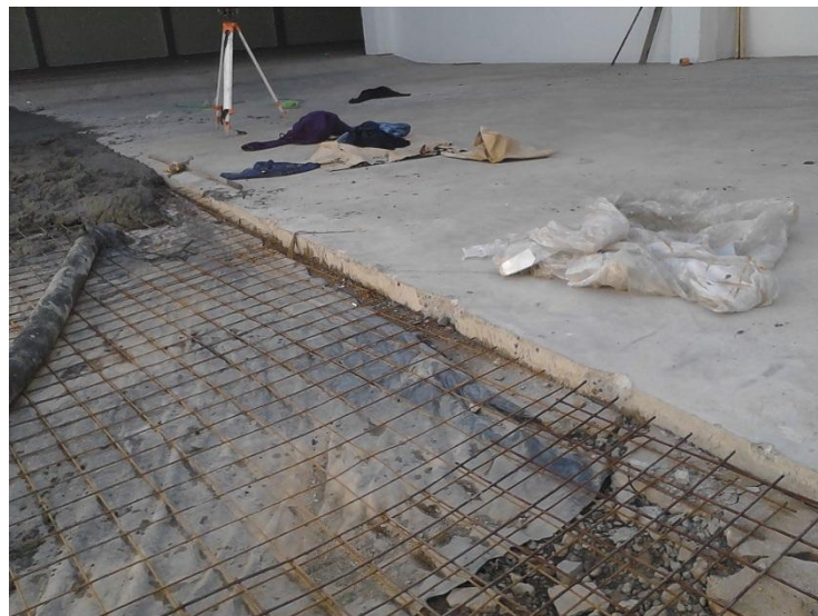
Figura 30 – Ausência das barras de transferência nas juntas de construção da obra E
