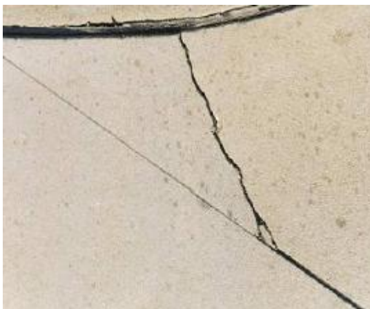
Figura 17 – Fissura gerada pelo posicionamento inadequado da junta serrada na interseção com a junta de encontro em curva
