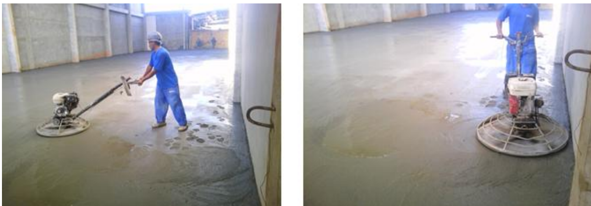
Figura 27 – Acabamento prematuro na obra C
