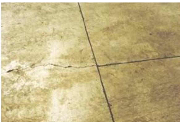
Figura 16 – Fissura gerada pela utilização de uma junta do tipo T
