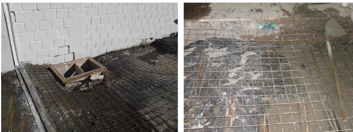
Figura 19 – Deficiência na colocação da lona plástica
