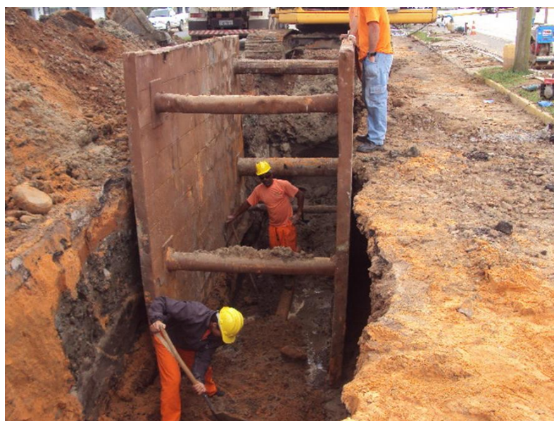
Figura 26 – Escoramento metálico utilizado na obra de Torres
