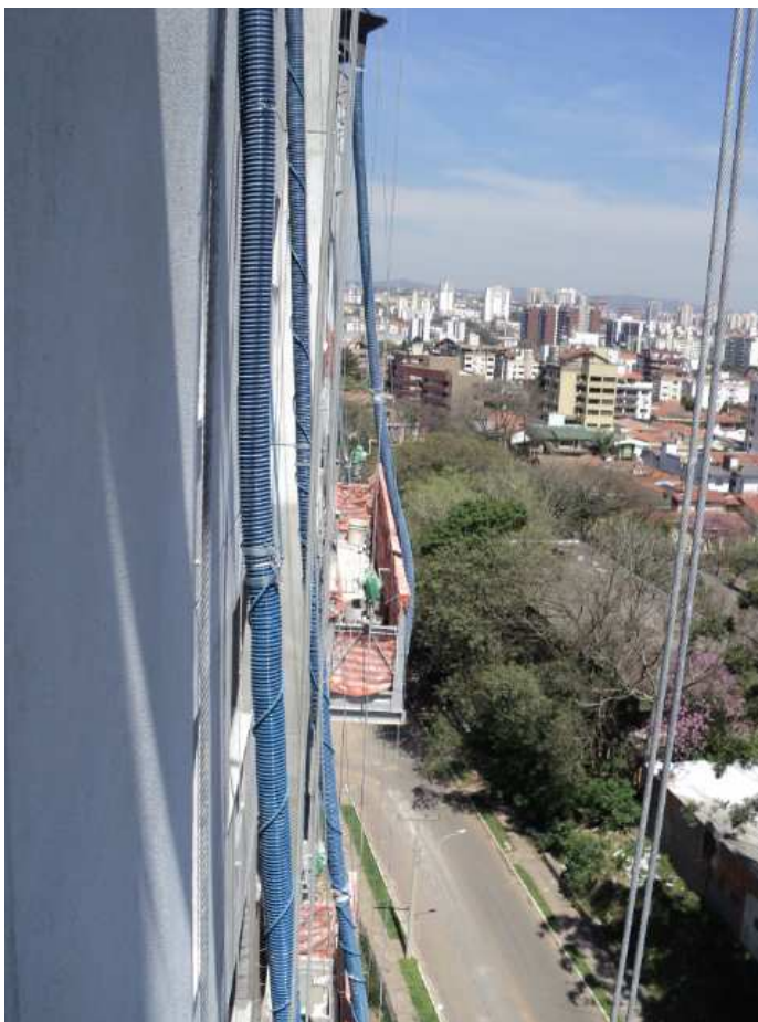
Figura 13 – Corda em volta do duto, prática recomendada para reduzir a velocidade da argamassa
