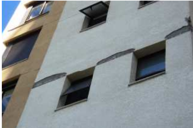
Figura 4 – Descolamento de placas de revestimento devido a não aderência do chapisco à viga
