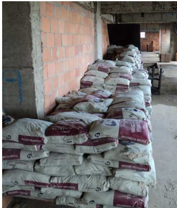
Figura 19 – Depósito de argamassa ensacada no pavimento onde será realizado o preparo da argamassa para o revestimento
