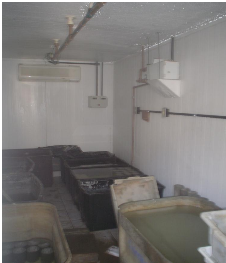
Figura 31 – Câmara com umidade e temperatura controladas
