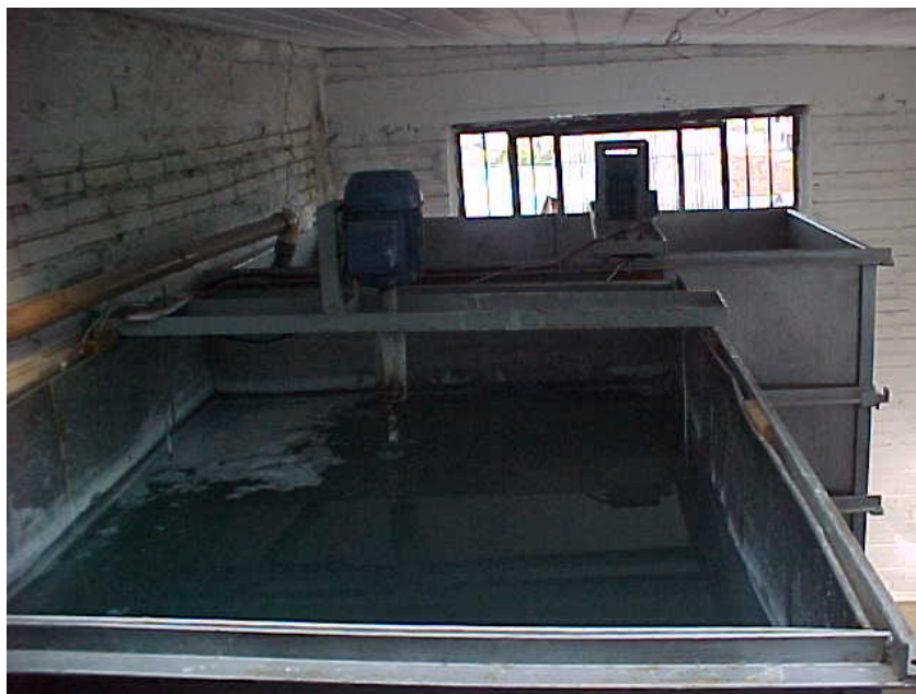
Figura 9. Tanques de coagulação/floculação para o tratamento do efluente.
