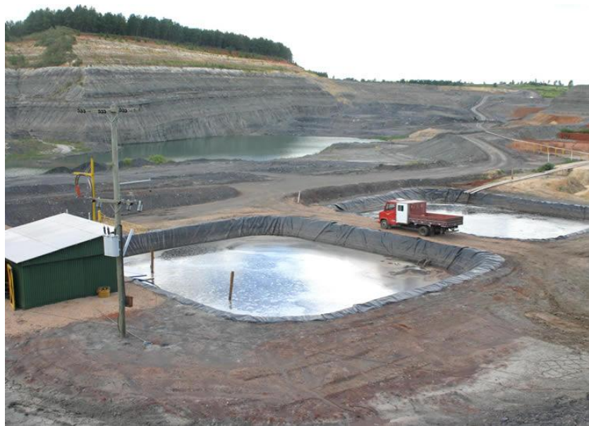
Figura 8: Lagoa de armazenamento de lixiviado do aterro CRR
