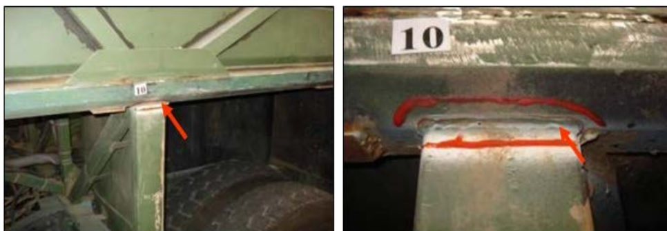
Figura 6.40 Trinca na carroceria atrás ao rodado traseiro
