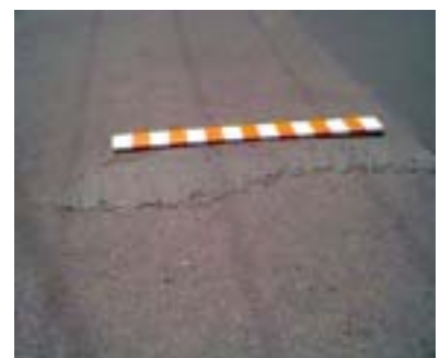
(c) Derrame de material
