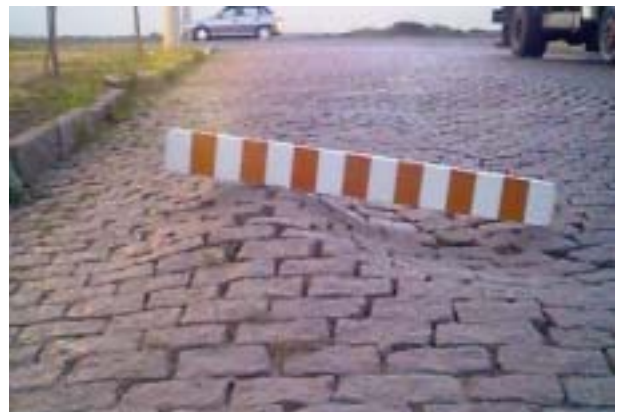
(b) Afundamento com solevamento lateral
