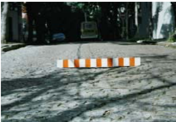
(a) Afundamento nas trilhas de rodas sem sollevamento lateral
