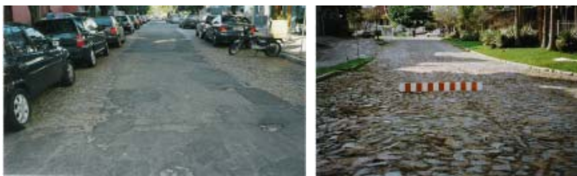
Figura 4.37 – Pavimentos de pedras irregulares em estado ruim
