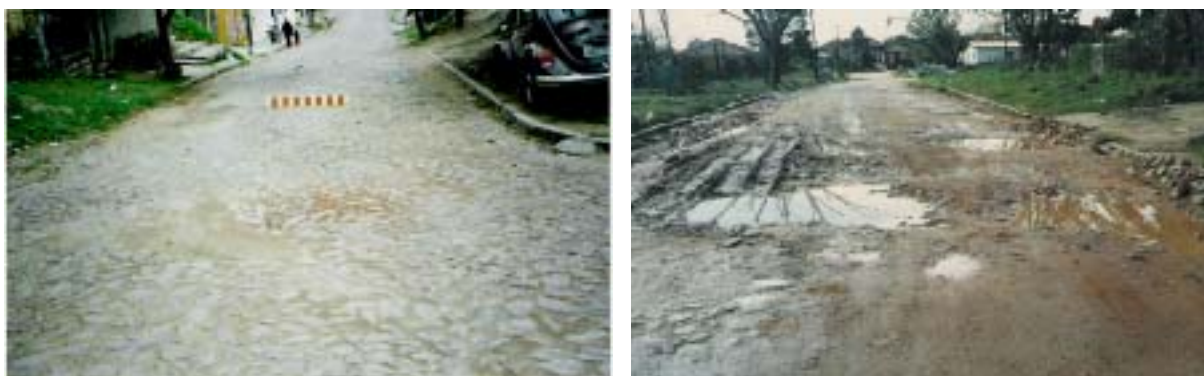
Figura 4.38 – Pavimentos de pedras irregulares em péssimo estado
