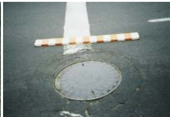
(b) Trincas concêntricas a tampa de PV
