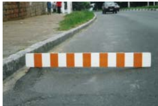
(b) Afundamento com sollevamento lateral
