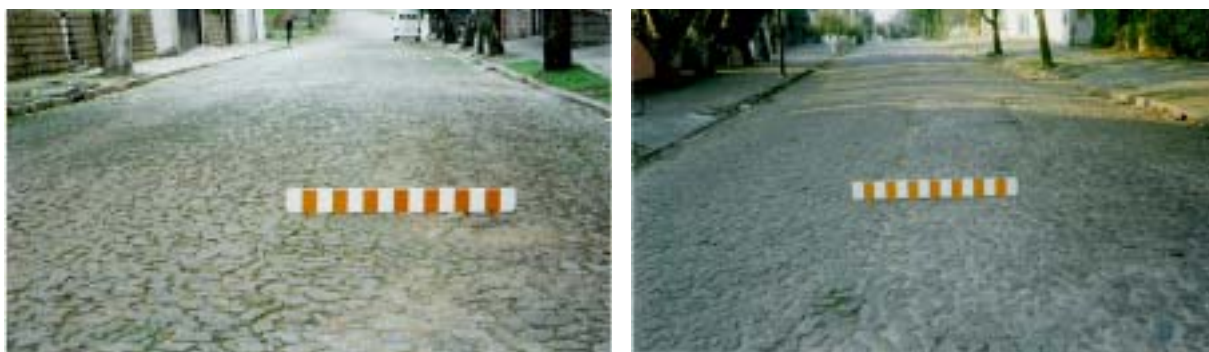
Figura 4.36 – Pavimentos de pedras irregulares em estado regular
