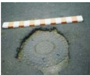
(a) Desnível em tampa de PV
