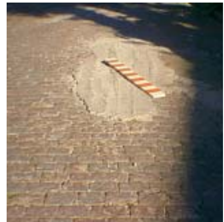
(b) Derrame de material
