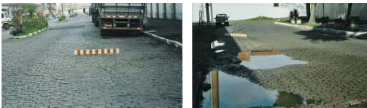
Figura 4.32 – Pavimentos de paralelepípedos em estado ruim
