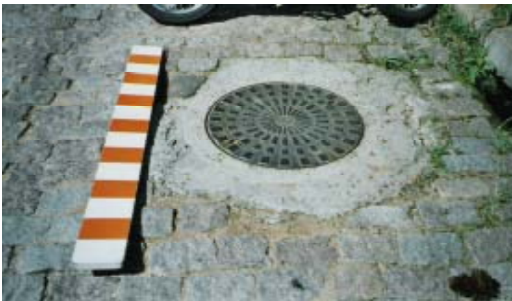
(a) Imperfeição no suporte de concreto de tampa de PV
