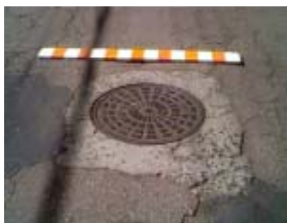
(b) Imperfeição em suporte de tampa de poço de visita
