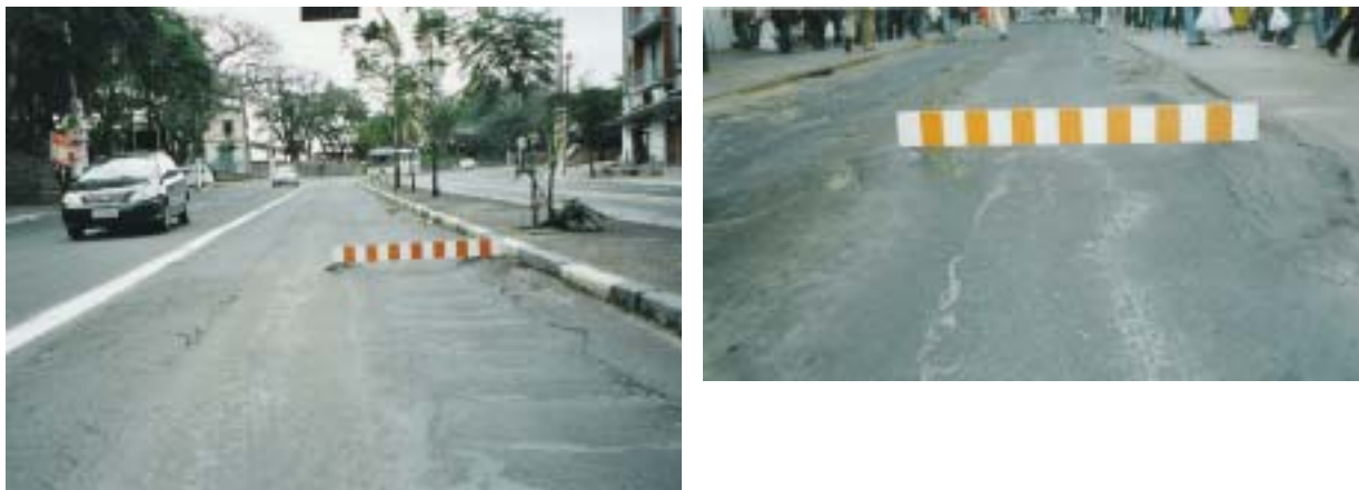
Figura 4.27 – Pavimentos com revestimento asfáltico em péssimo estado
