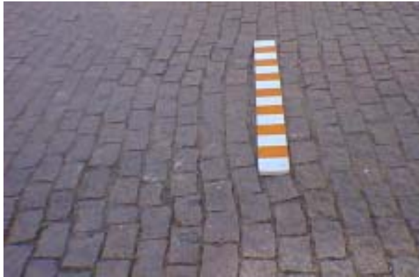
Figura 4.20 – Defeitos em pavimentos com paralelepípedos: deformação por aceleração frenagem ou mudança de direção
