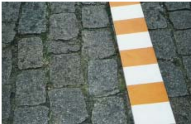
(a) Peças trincadas ou quebradas
