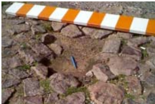
Figura 4.21 – Defeitos em pavimentos com pedras irregulares: panela
