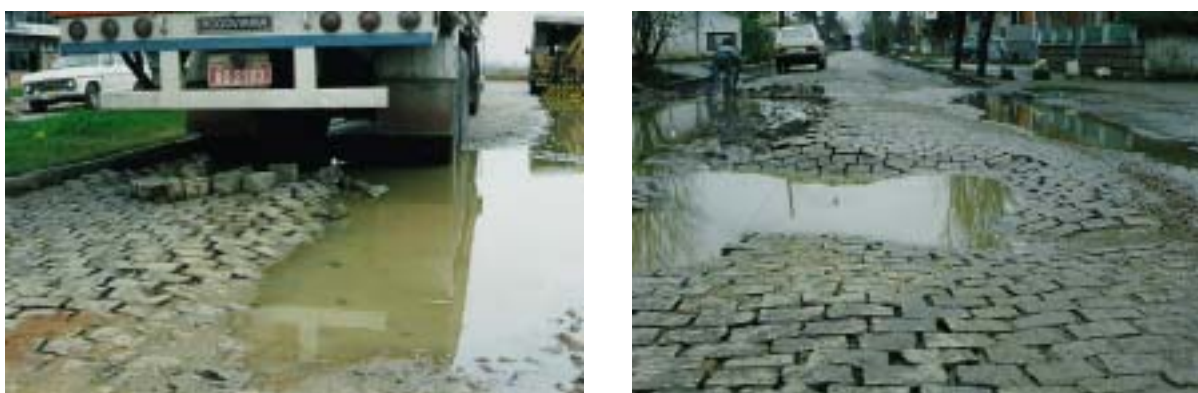
Figura 4.33 – Pavimentos de paralelepípedos em péssimo estado
