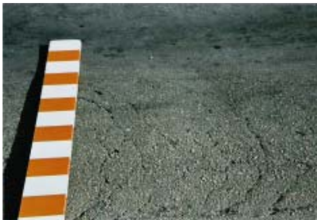
(a) Trincas parabólicas
