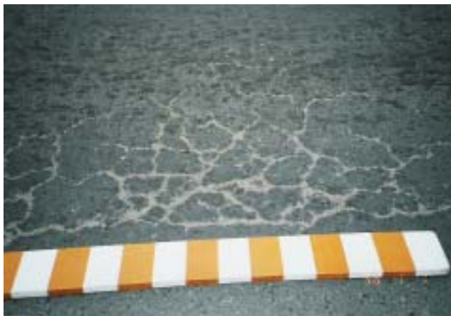
(a) Trincas de fadiga
