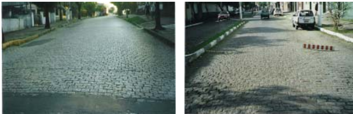
Figura 4.31 – Pavimentos de paralelepípedos em estado regular
