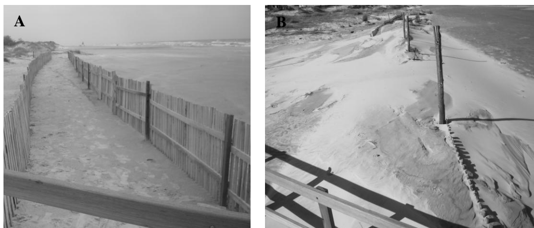
FIGURA Nº 11 - Uso de cercas para construção de dunas. (A) cercas recém-instaladas; (B) duna com mais de 1 m, 10 meses após a instalação. Fotografia: Luana Portz, (A) 18 de janeiro de 2010; (B) 10 de novembro de 2010.
